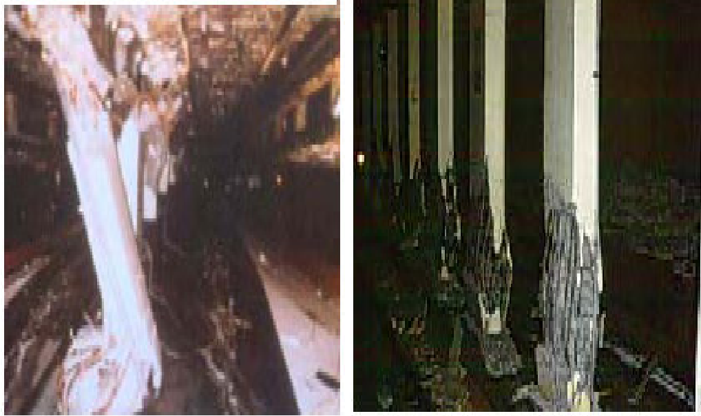
Şekil 2.4 : Daikai Metro İstasyonu Kobe depremi sonrası (Uenishi ve Sakurai, 2000)
