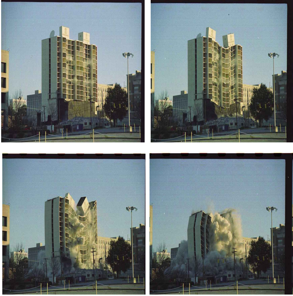
Şekil 8.5 : Kendi İçine Çökerek Yıkılan Bir Bina Örneği
