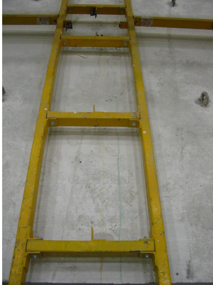
Şekil 7.43: P10 Plağı Üst Yüzeyinin Çatlak Doğrultusu
