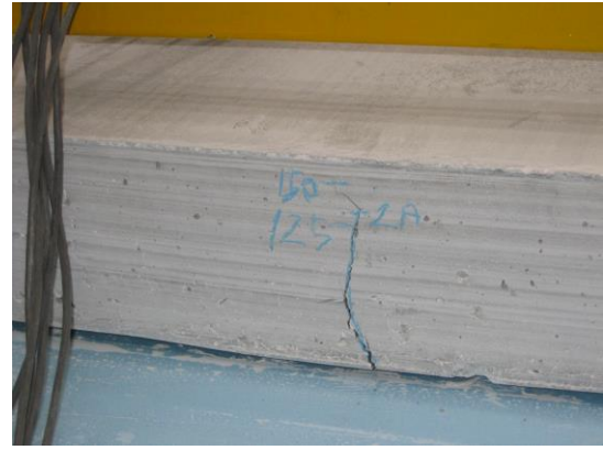
Şekil 7.35: P9 Plağı 2A Çatlağı
