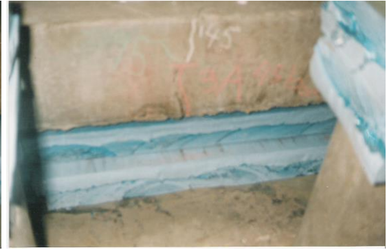
Şekil 7.6: P5 Plağı 3A Çatlakları
