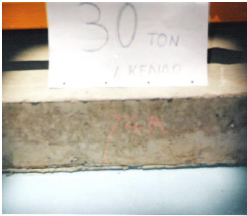
Şekil 7.13: P6 Plağı 4A Çatlağı
