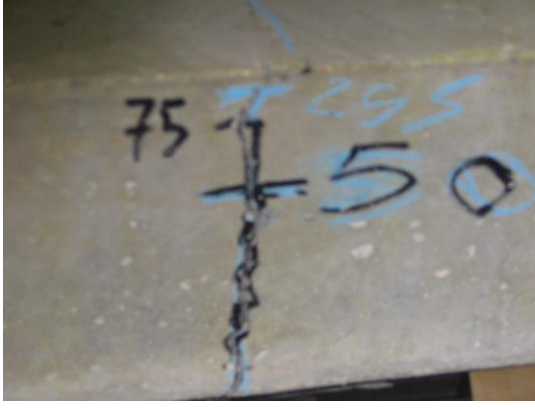
Şekil 7.19: P7 Plağı 1A Çatlağı
