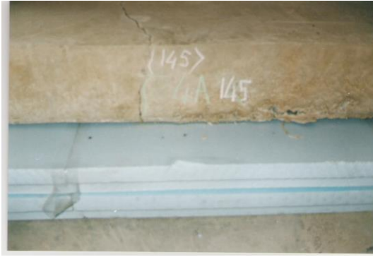
Şekil 7.5: P5 Plağı 4A Çatlakları
