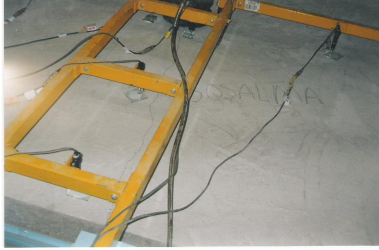
Şekil 7.15: P6 Plağı Üst Yüzeyinin Çatlak Doğrultusu
