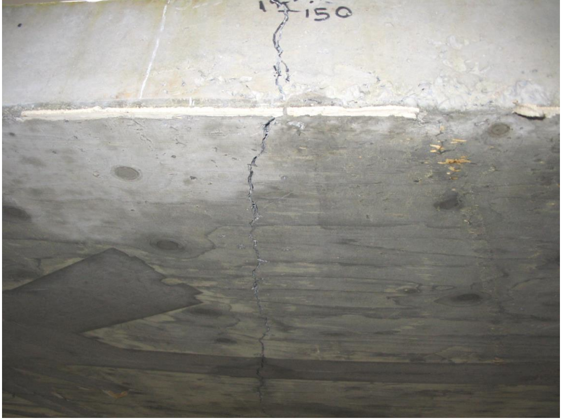
Şekil 7.23: P7 Plağının Alt Yüzeyinin Kırılma Sonrası Görünümü
