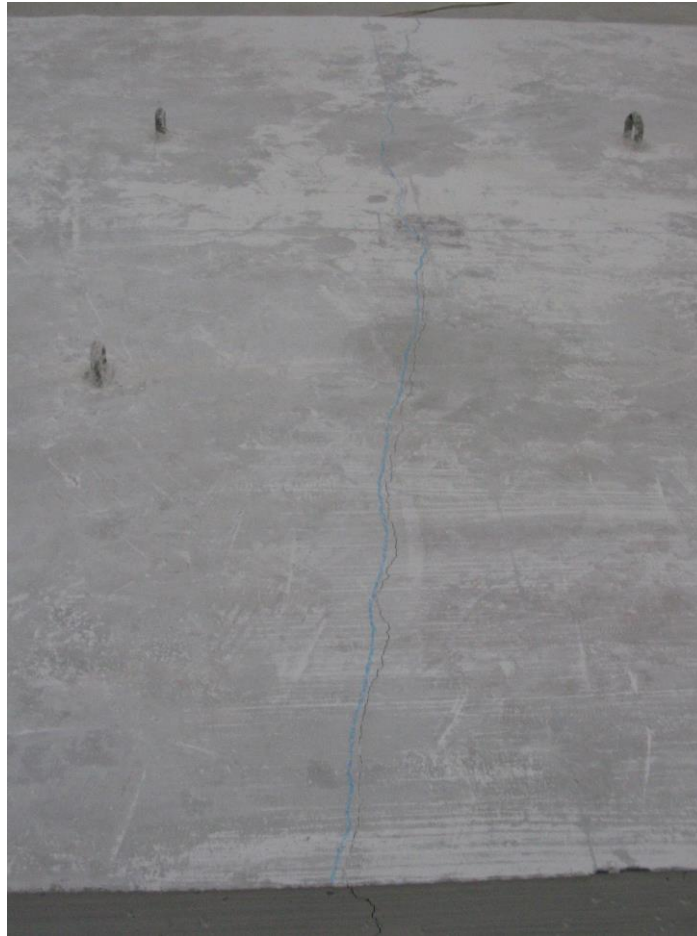
Şekil 7.29: P8 Plâğı Üst Yüzeyinin Çatlak Doğrultusu
