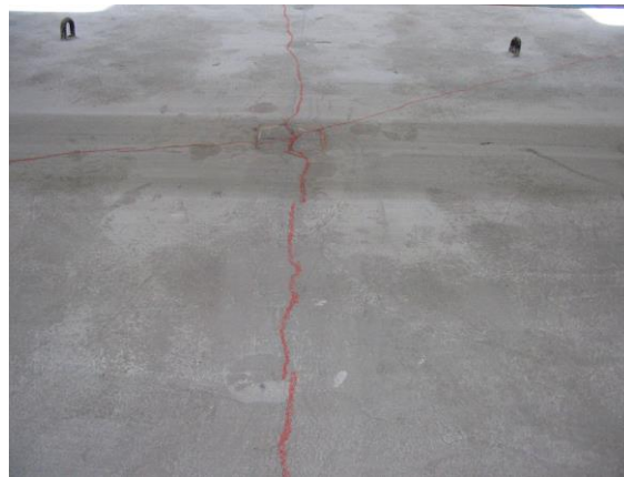
Şekil 7.36: P9 Plağı Üst Yüzeyinin Çatlak Doğrultusu
