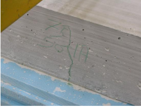
Şekil 7.41: P10 Plağı 1A Çatlağı
