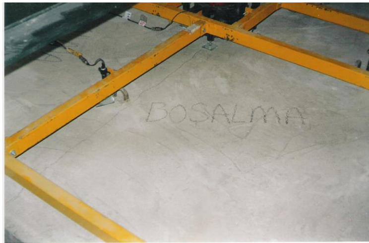
Şekil 7.7: P5 Plağı Üst Yüzeyinin Çatlak Doğrultusu
