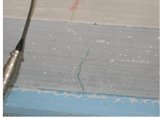
Şekil 7.42: P10 Plağı 3A Çatlağı
