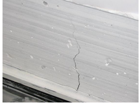
Şekil 7.28: P8 Plâğı 3A Çatlağı
