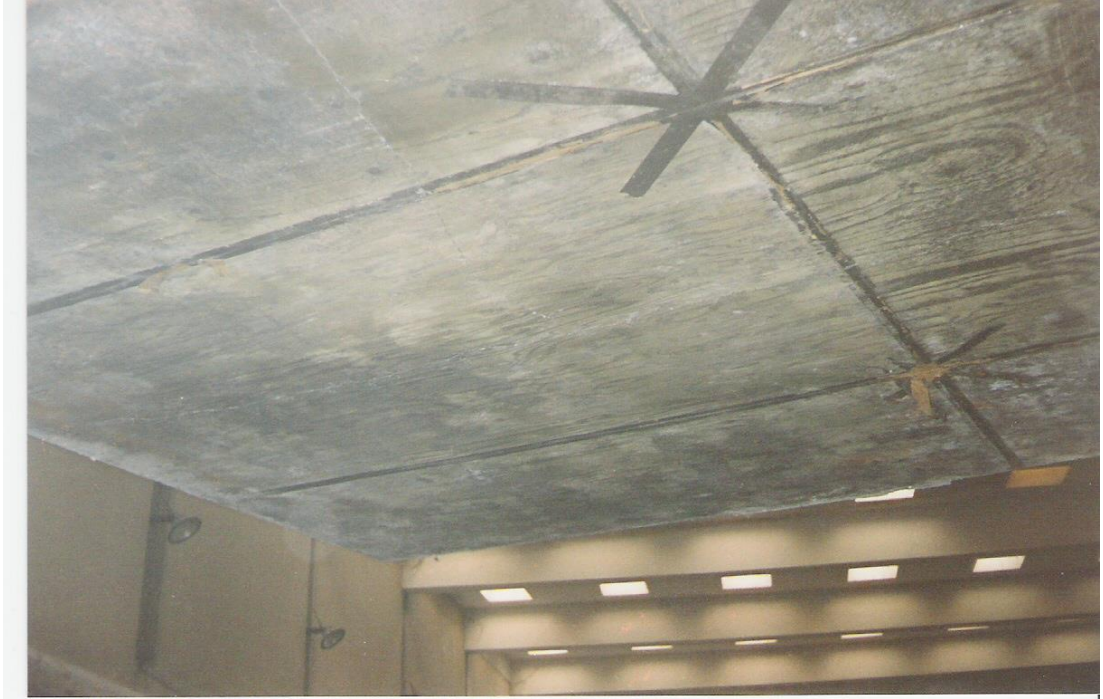
Şekil 7.9: P5 Plâğının Alt Yüzeyinin Kırılma Sonrası Görünümü
