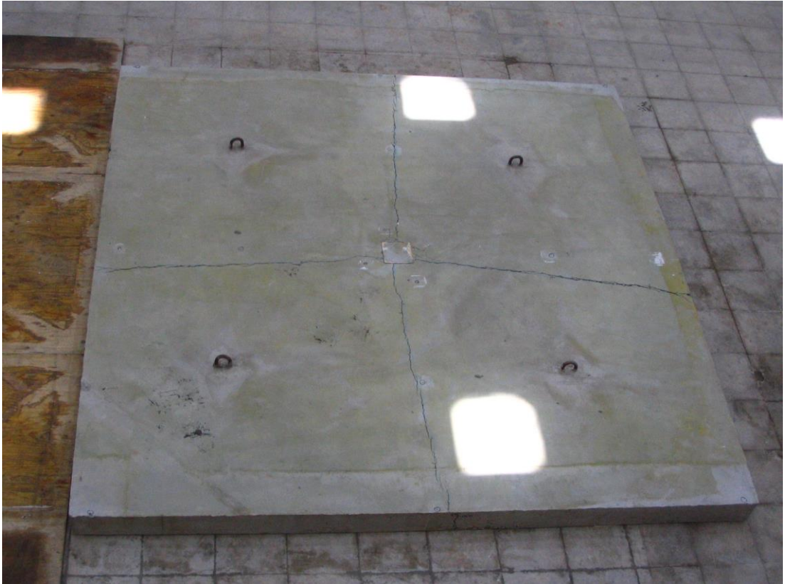
Şekil 7.21: P7 Plağı Üst Yüzeyinin Çatlak Doğrultusu
