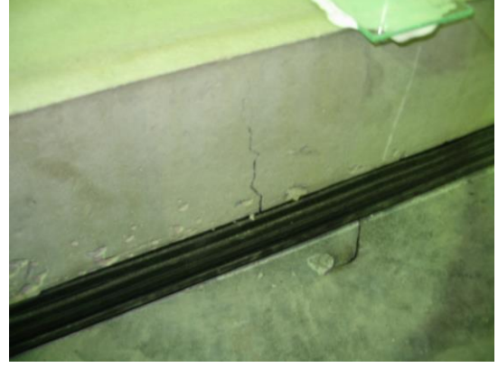
Şekil 7.20: P7 Plağı 4A Çatlağı
