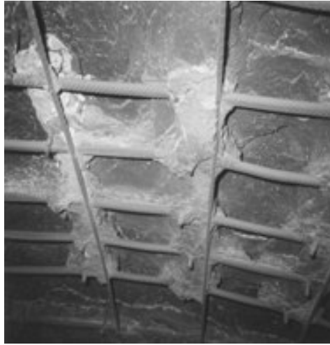
Şekil 2.14. Manş Tünelinde 1996 yılındaki yangın sırasında beton yüzeyinde görülen dökülmeler [29].
