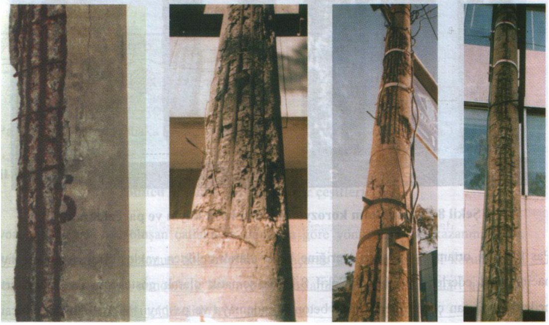
Şekil 2.28: İzmir’de korozyon hasarına uğramış elektrik direkleri
