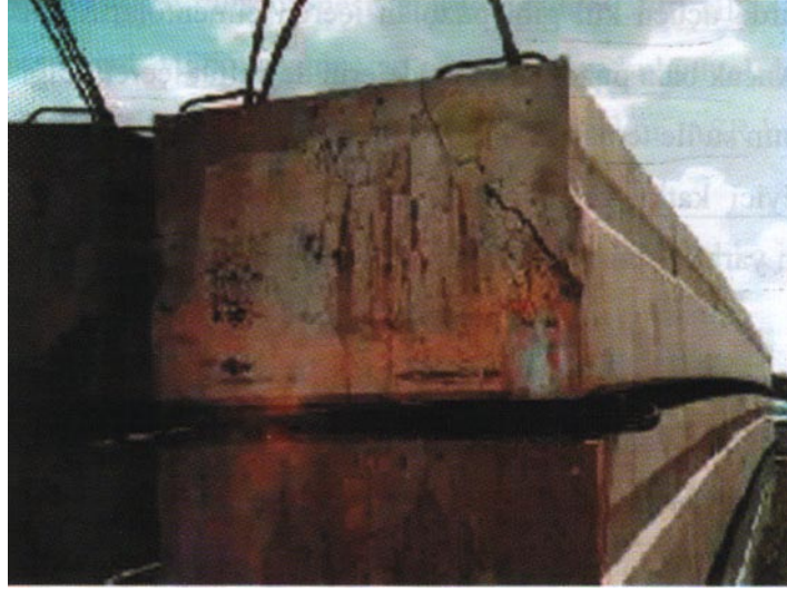
Şekil 2.13: Prefabrik betonarme bir elemanda DEF hasarı
