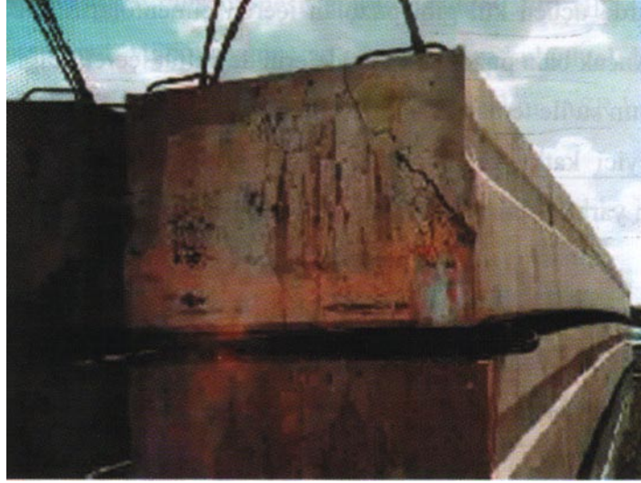
Şekil 2.14: Prefabrik Betonarme Bir Elemanda DEF Hasarı [55]
