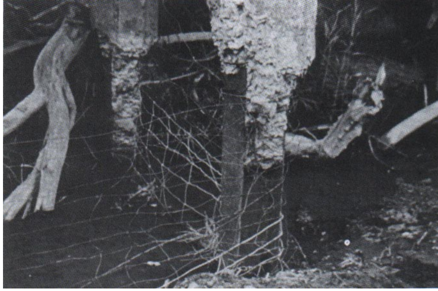
Şekil 2.9: Sülfat Etkisiyle Beton Elemanların Hasara Uğraması a) Betonarme Bir Elemanın Bozulması [55]
