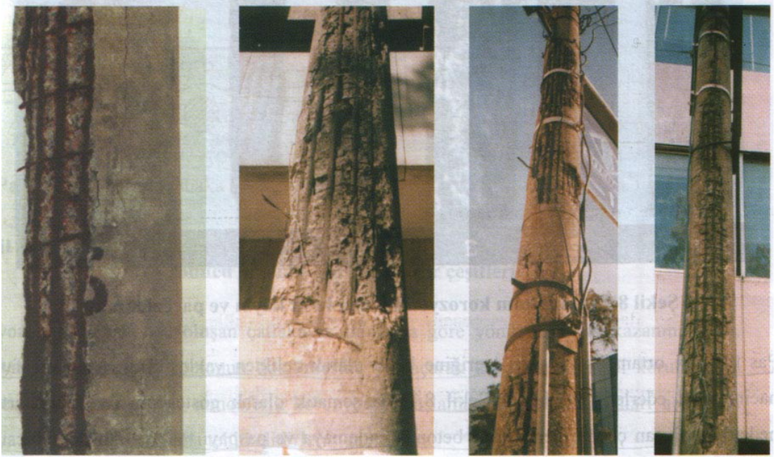
Şekil 2.26: İzmir’de Korozyon Hasarına Uğramış Elektrik Direkleri [55]
