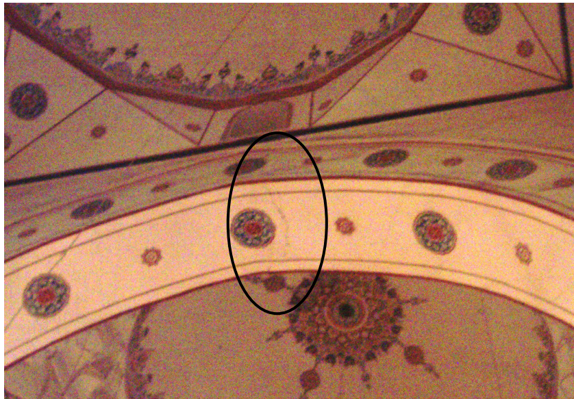
Şekil 4.7: Murat Paşa Camii büyük kemerdeki çatlak
