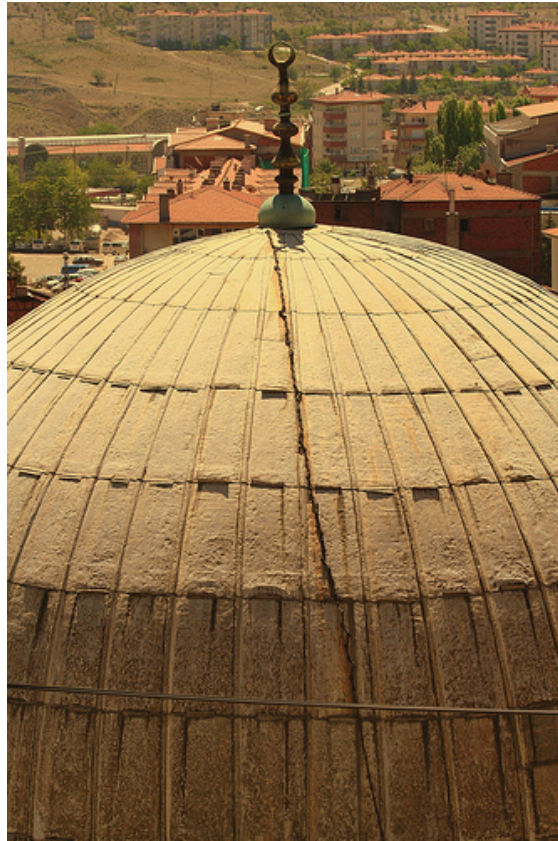
Şekil 2.16: Kubbede hasar oluşumu
