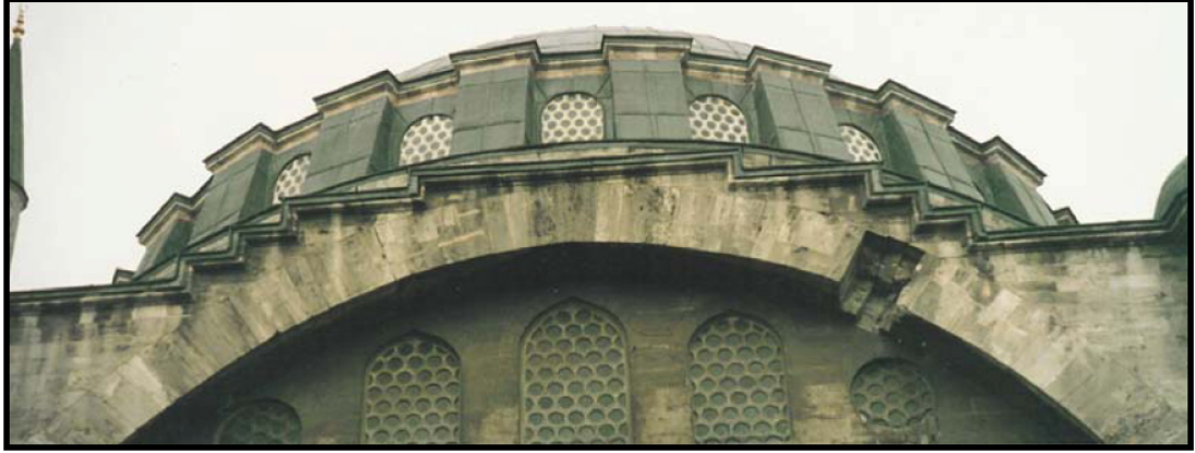
Şekil 2.13: 17 Ağustos 1999 Kocaeli depreminden sonra Edirnekapi Mihrimah Sultan Camii kemerinde oluşan hasar [42]
