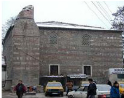
Şekil 3.7: 12 Kasım 1999 Düzce Depremi'nde İmaret Camii minaresinde oluşan hasar.[14]
