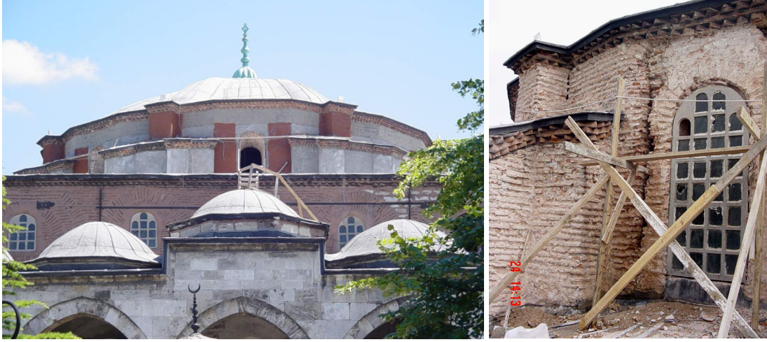
Şekil 3.14: Küçük Ayasofya Camii kubbe kasnağında hasar [13]
