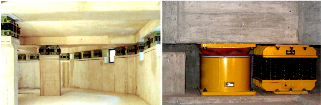
Şekil 3.21: Yapının bodrum katında elastomer mesnetli sismik yalıtım uygulaması [37]
