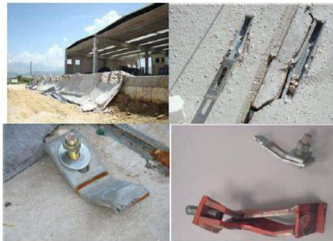
Şekil 2.2 : L'Aquila Depremi sonrası bağlantı elemanlarındaki hasarlar, (SafeCladding çalışma takımı, 2012).
