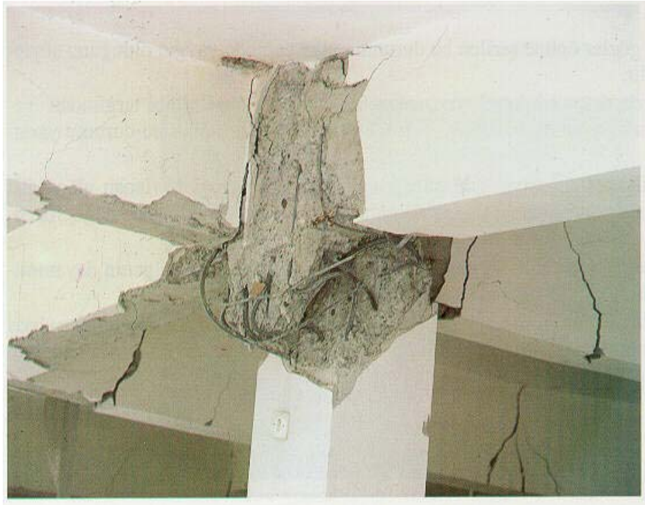
Şekil 2.3: Düğüm noktası hasarı
