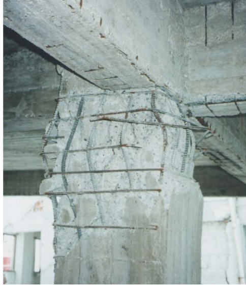
Şekil 1.1 : 1999 Kocaeli Depreminde hasar görmüş bir kolon (Ilki,2006).
