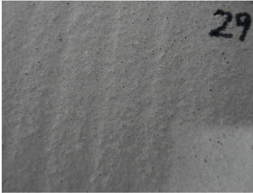
Şekil H-5: BYG-2 katkılı harç çatlak takibi
