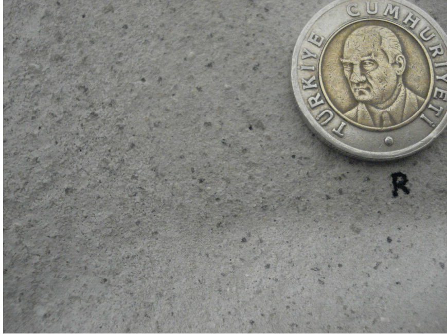
Şekil H-6: Referans harç çatlak takibi
