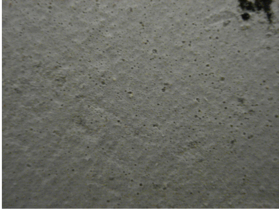
Şekil H-1: BYG katkılı harç çatlak takibi
