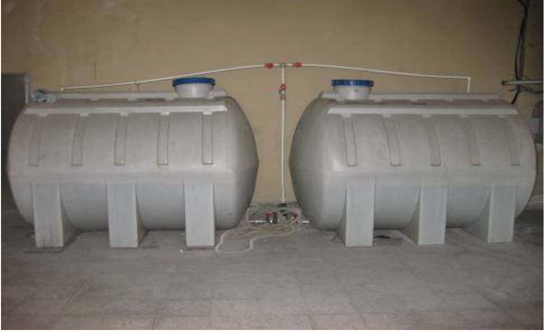
Şekil 3.10 : Ham su depolama tankları (5'er ton'dan 2 adet, toplam 10 ton kapasiteli)
