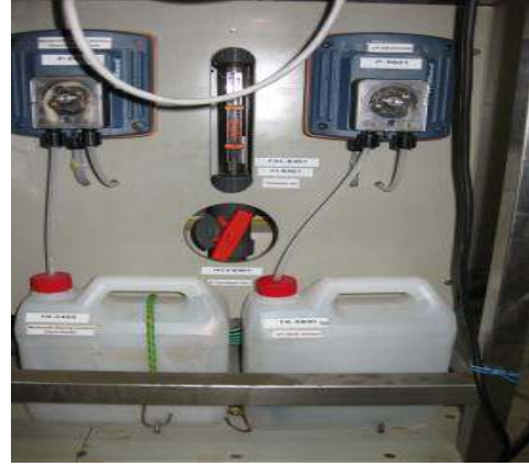
Şekil 3.19 : Asit dozlama pompası ve tankı
