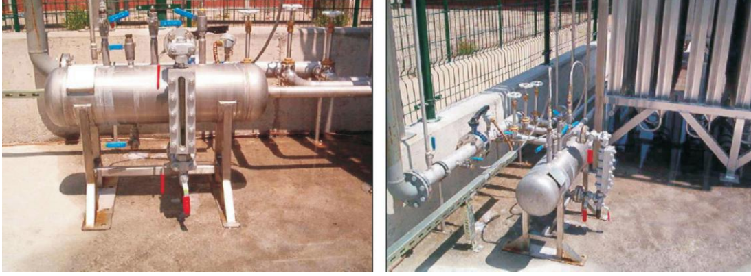
Şekil 3.8 : Gaz kaçağı algılama sistemi
