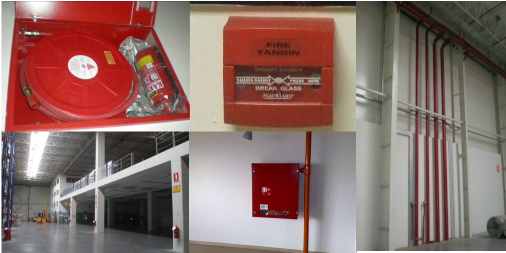
Şekil 6.21 : Tesis yangın güvenliği.
