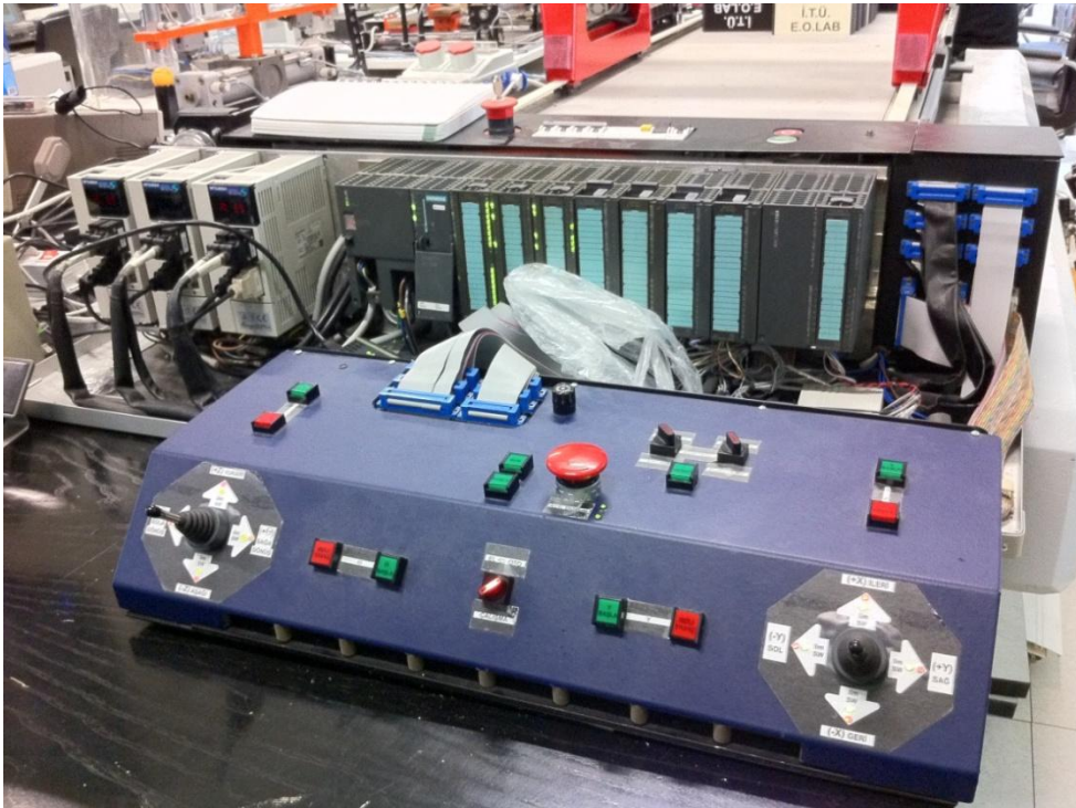
Şekil 2.3 : GKVS'nin kontrol ve operatör kısmı.
