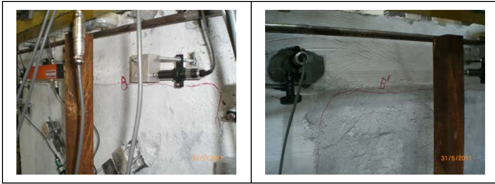
Şekil 3.47 : 3. çevrim sırasında oluşan çatlaklar.
