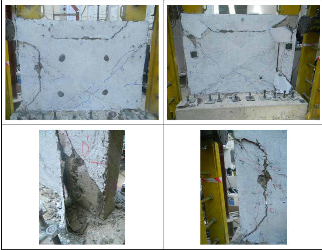
Şekil 3.100 : Deney sonunda numunedeki hasar durumu.
