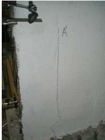
Şekil 3.71 : 7. çevrim sırasında oluşan çatlak.
