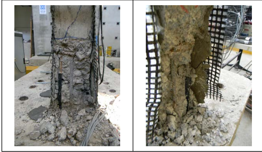
Şekil 3.80 : 14. çevrim sonunda numune oluşan hasar durumu.
