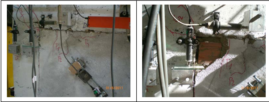
Şekil 3.55 : 10. çevrim sırasında oluşan çatlaklar.
