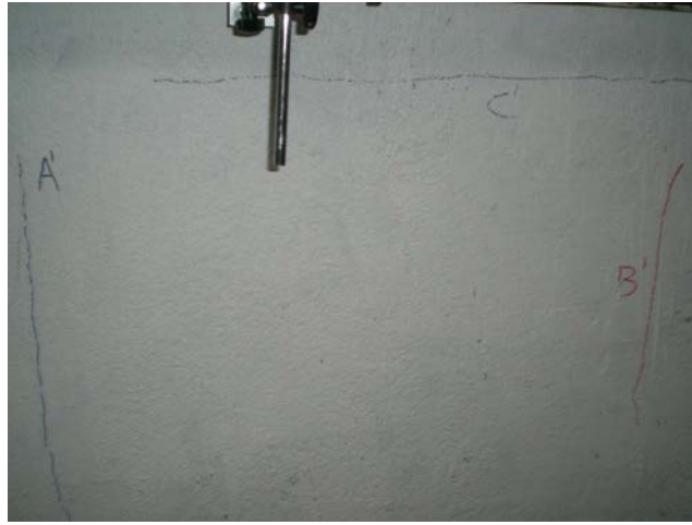
Şekil 3.73 : 10.çevrim sonunda oluşan çatlak.
