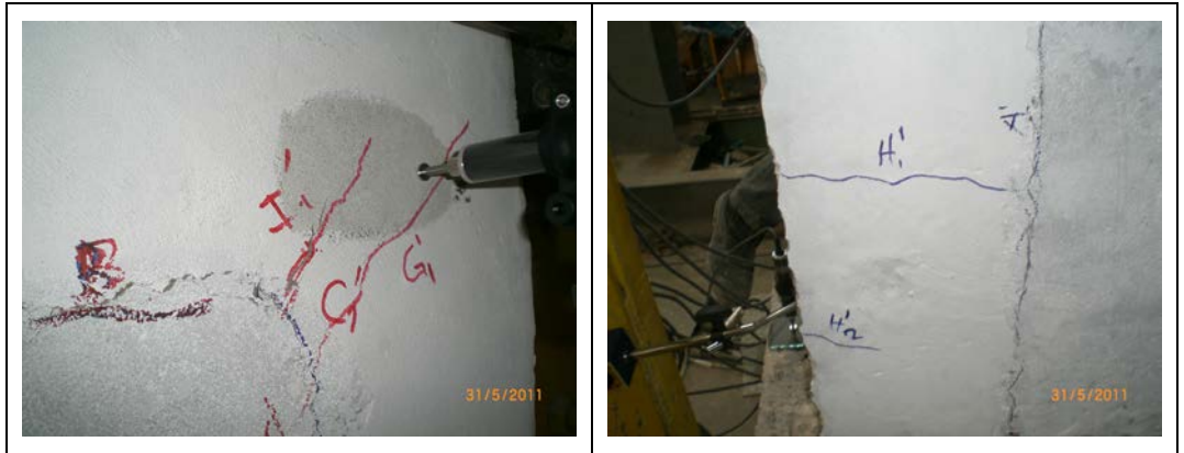
Şekil 3.50 : 5. çevrim sırasında oluşan çatlaklar.
