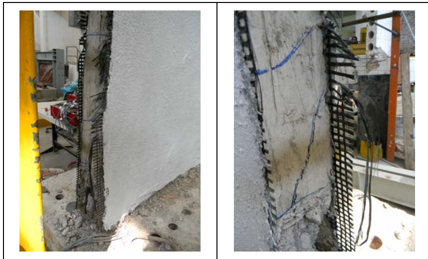
Şekil 3.79 : 13. çevrim sırasında ilerleyen hasarlar.
