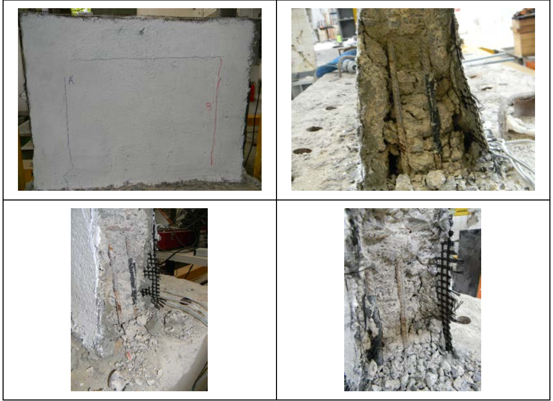
Şekil 3.76 : 13. çevrim sonunda oluşan hasar durumu.
