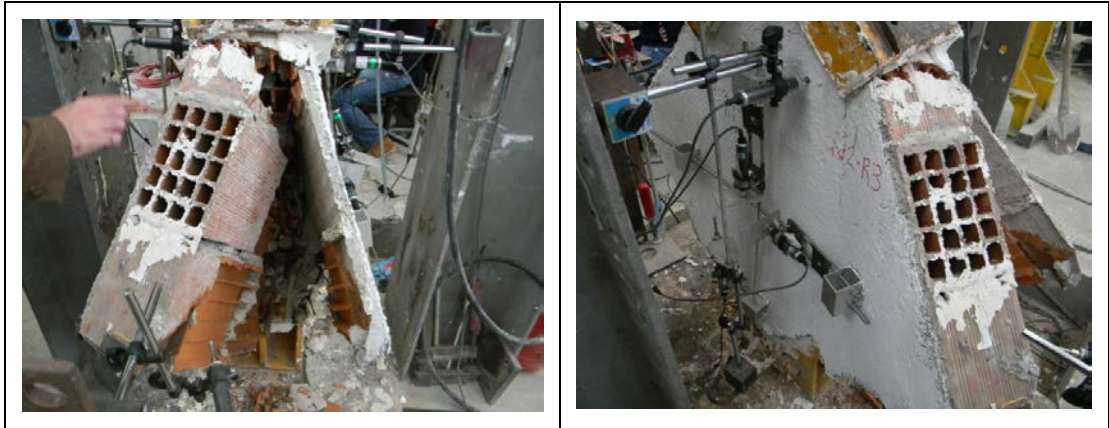
Şekil 2.31 : GN-2-1-2 numunesinin ön ve arka yüzlerinin göçme sonrası durumu
