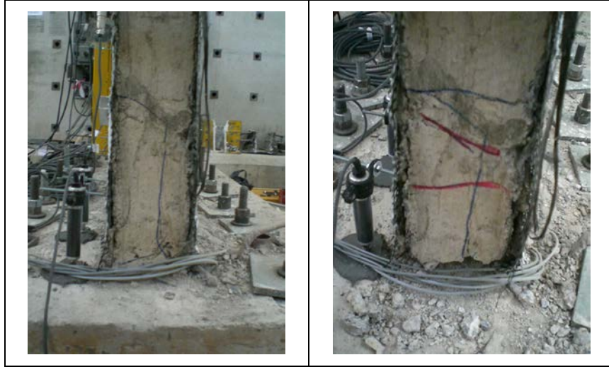
Şekil 3.78 : Kolon diplerinde oluşan hasarlar.
