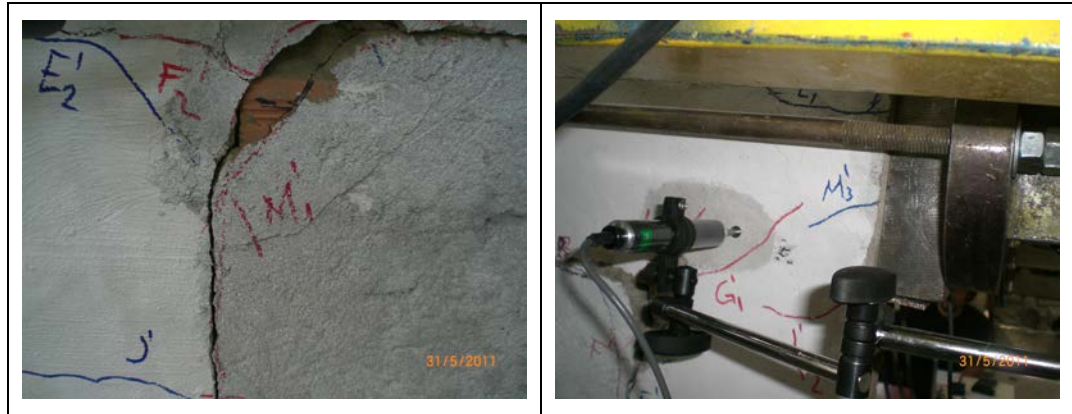
Şekil 3.53 : 8. çevrim sırasında oluşan çatlaklar.
