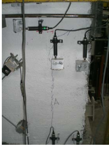
Şekil 3.70 : 6. çevrim sırasında oluşan çatlak.
