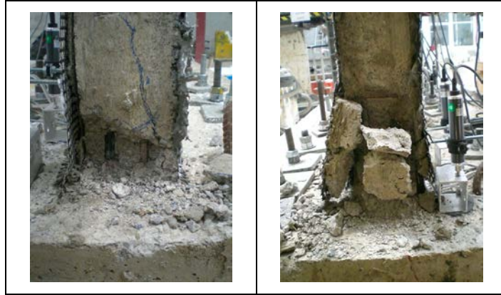
Şekil 3.105 : 12. çevrimde donatıların açığa çıkması.
