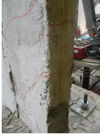
Şekil 3.87 : Çatlağın ön yüze doğru ilerlemesi.
