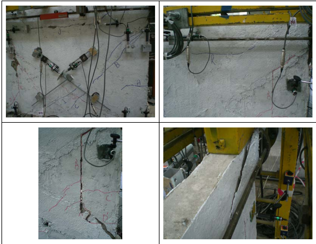
Şekil 3.99 : 11. çevrim sonunda numunedeki hasar durumu.
