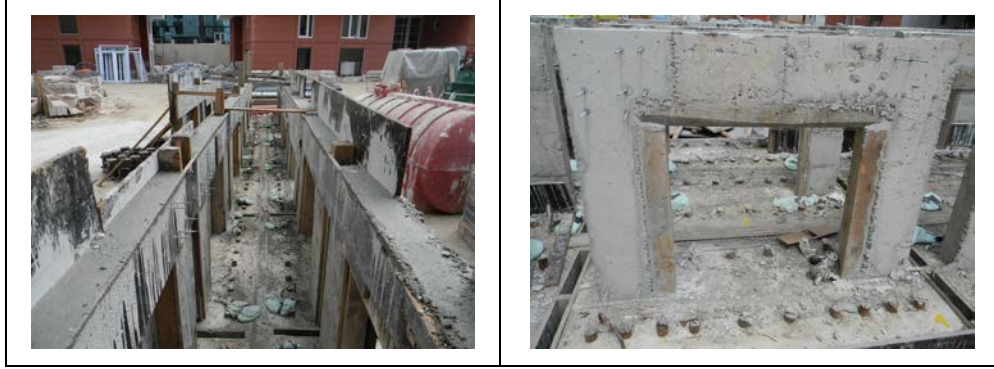
Şekil 3.10 : Beton dökülmüş çerçeveler.
