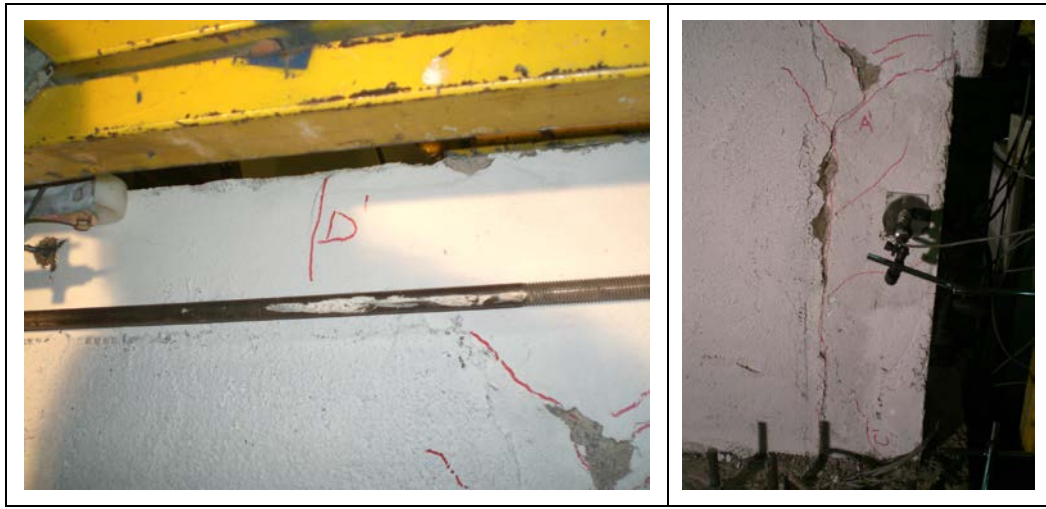
Şekil 3.85 : 8. çevrim sırasında oluşan çatlaklar.
