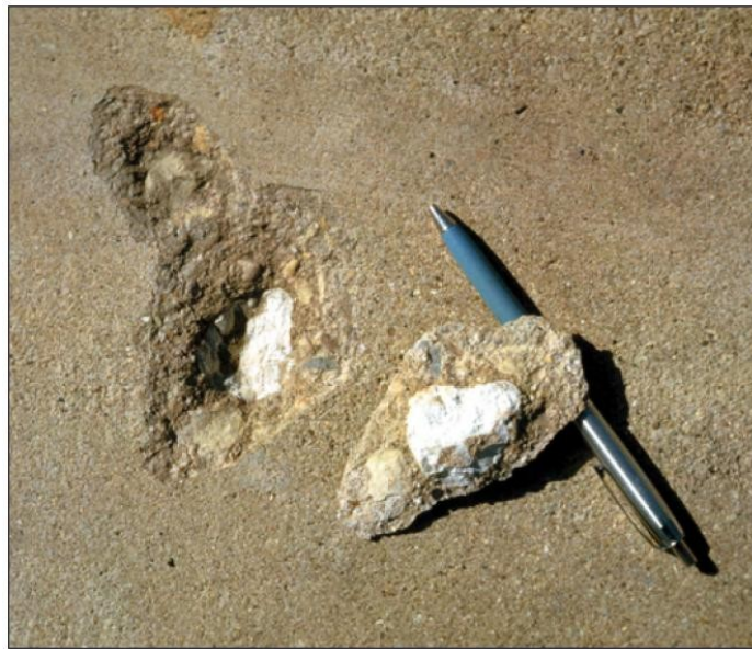
Şekil 3.11 : Beton yüzeyindeki bir açılma [11].
