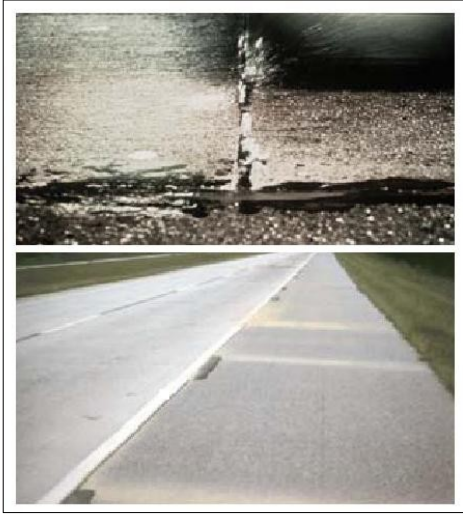
Şekil 3.6 : Pompaj olayı görüntüsü (üstte) ve bankette pompajdan kaynaklanan lekeler (altta) [12].
