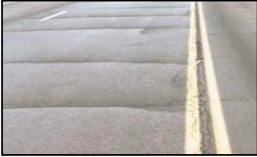
Şekil 4.20: Termal (enine) çatlak [11].
