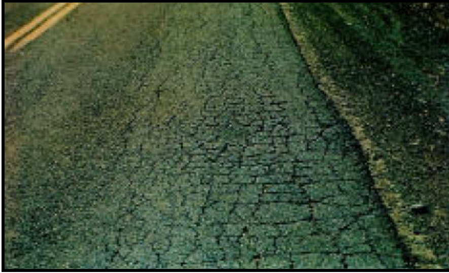
Şekil 4.15: Timsah sırtı çatlağı [1].
