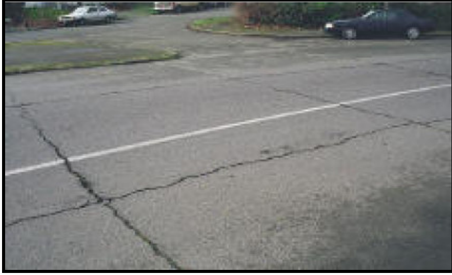
Şekil 4.38: Yüksek şiddette yansıma çatlakları [14].
