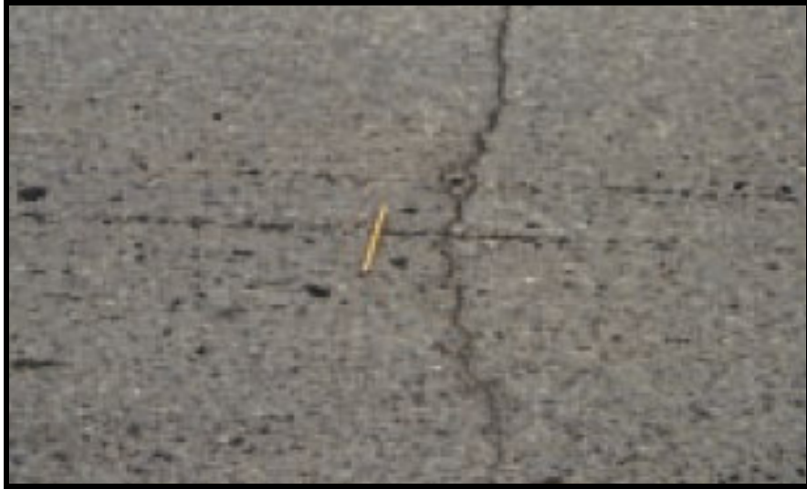
Şekil 4.23: Orta şiddette termal çatlak [1].
