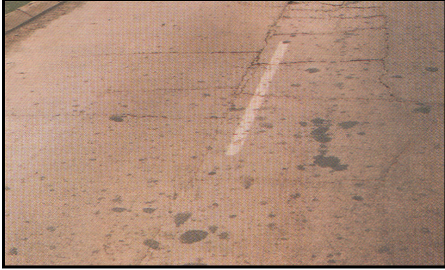
Şekil 4.34: Hafif şiddette blok çatlakları [1].
