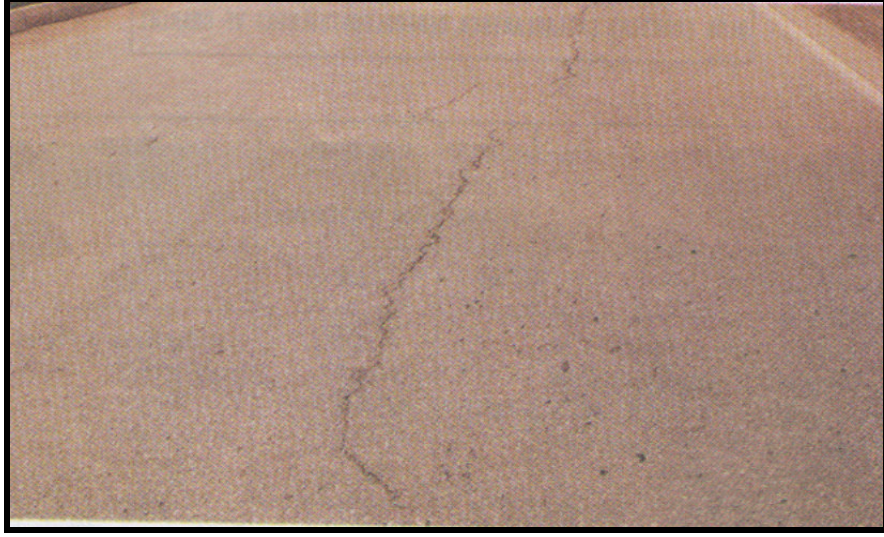
Şekil 4.30: Hafif şiddette boyuna çatlak [1].
