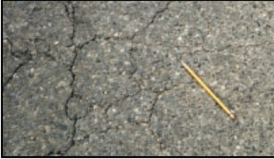
Şekil 4.17: Hafif şiddette yorulma çatlakları (timsah sırtı çatlakları) [1].
