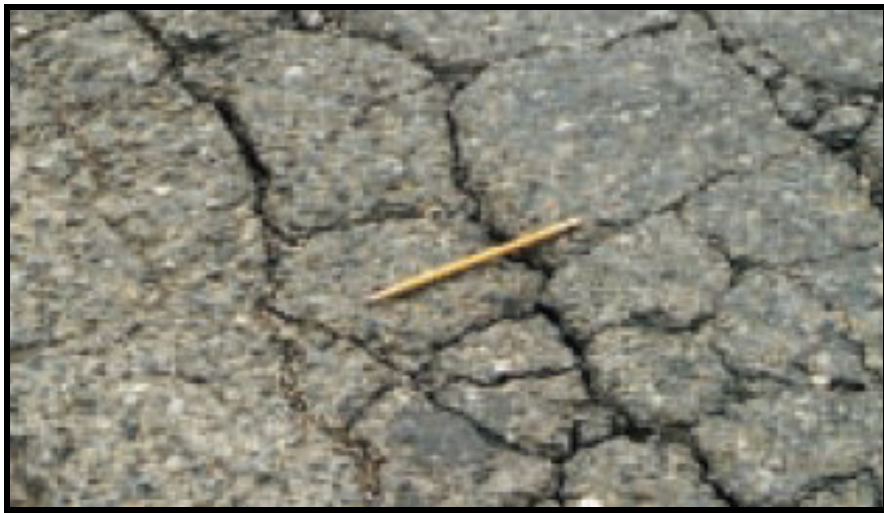
Şekil 4.19: Yüksek şiddette yorulma çatlağı [1].
