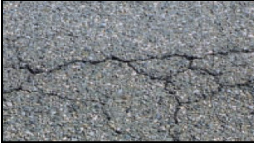
Şekil 4.18: Orta şiddette yorulma çatlağı [1].
