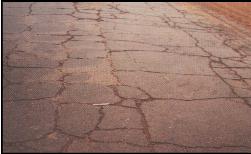
Şekil 4.36: Yüksek şiddette blok çatlaklar [1].
