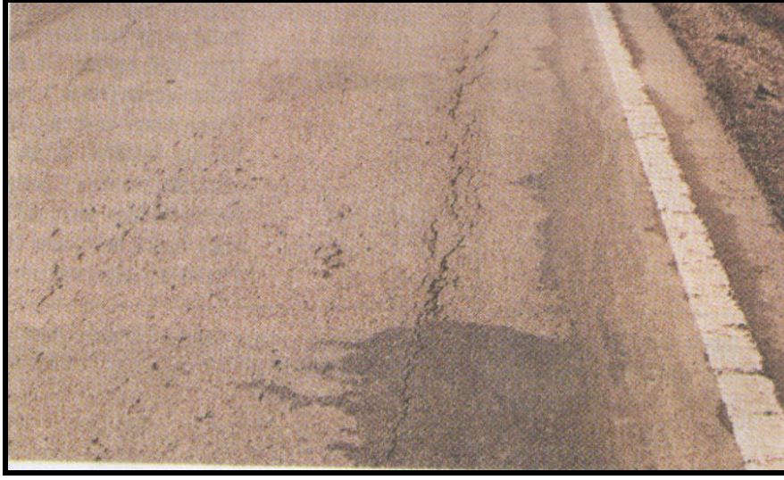
Şekil 4.31 Orta şiddette boyuna çatlak [1].
