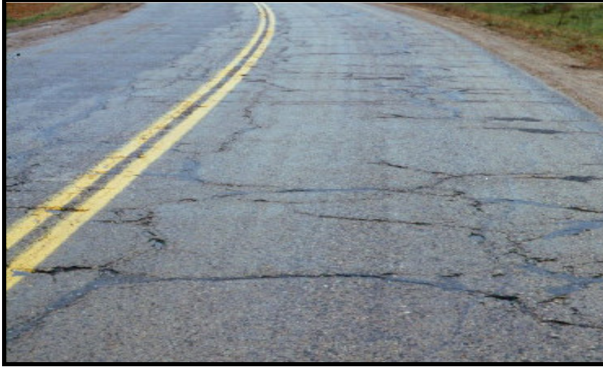
Şekil 4.35: Orta şiddette blok çatlaklar [1].
