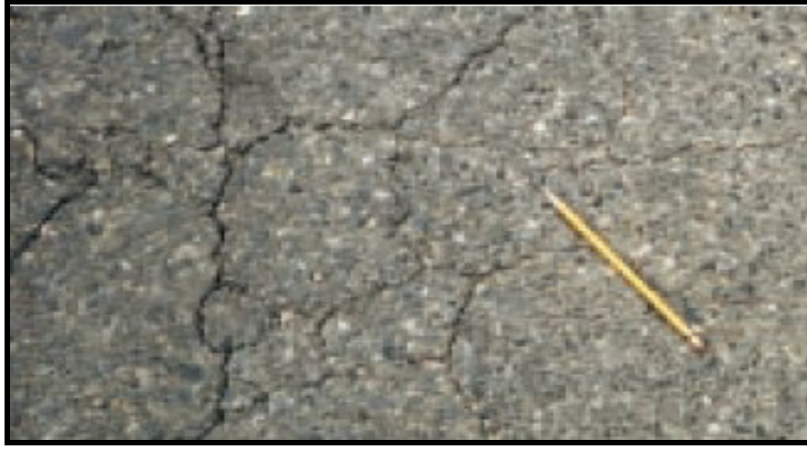
Şekil 4.26: Hafif şiddette kenar çatlağı [1].
