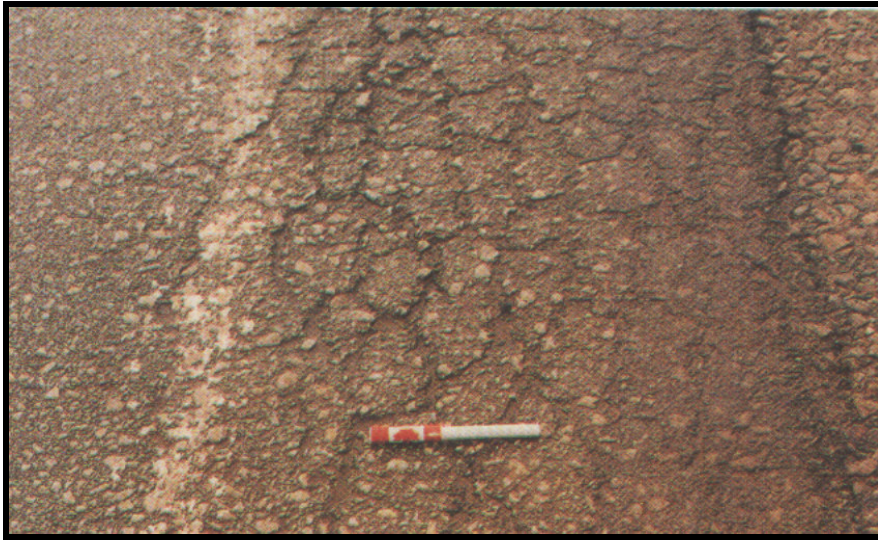
Şekil 4.28: Yüksek şiddette kenar çatlağı [1].
