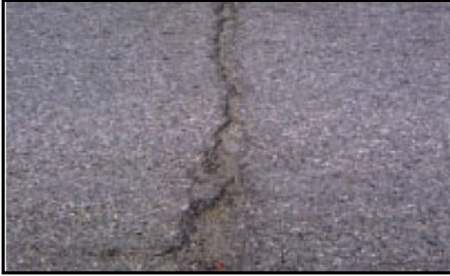
Şekil 4.24: Yüksek şiddette termal çatlak [1].
