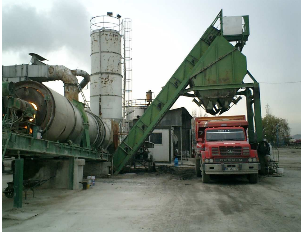
Şekil 2.29: Biriktirme Deposu (Karayolları 4. Bölge Müdürlüğü)
