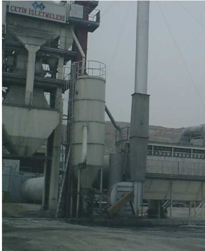
Şekil 2.15: Filler Silosu (Çetin İşletmeleri, Ağırlıklı Tip Asfalt Plenti, Ankara)
