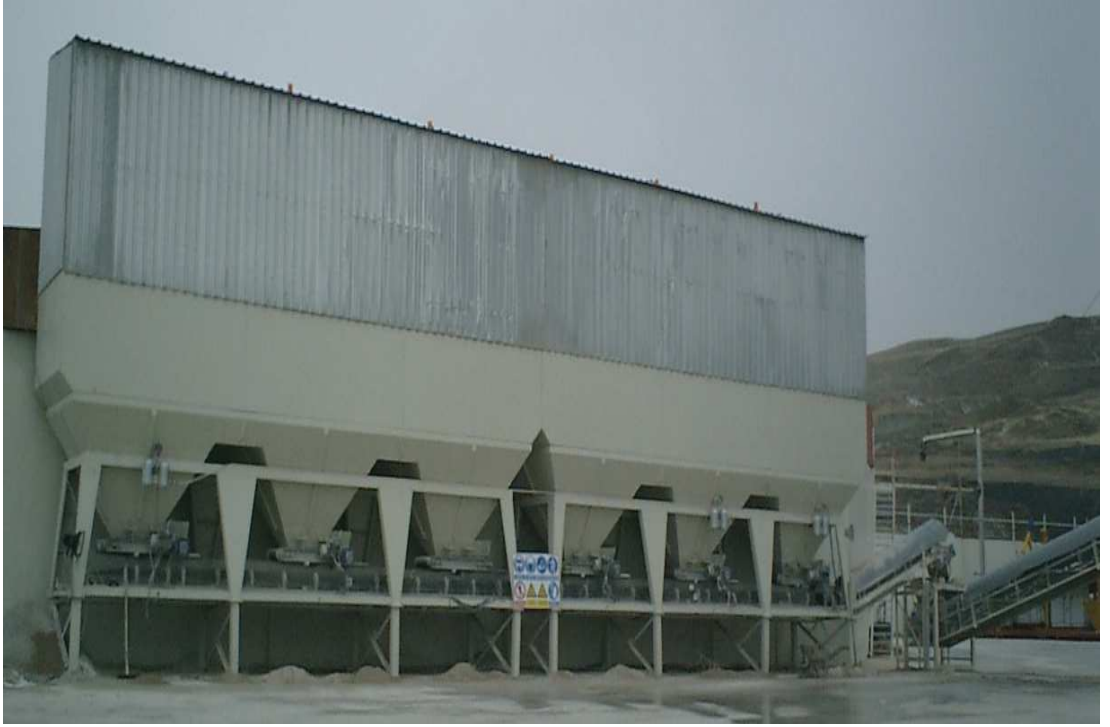
Şekil 2.7: Soğuk Agregat Bunkerleri (Çetin İşletmeleri, Ankara)
