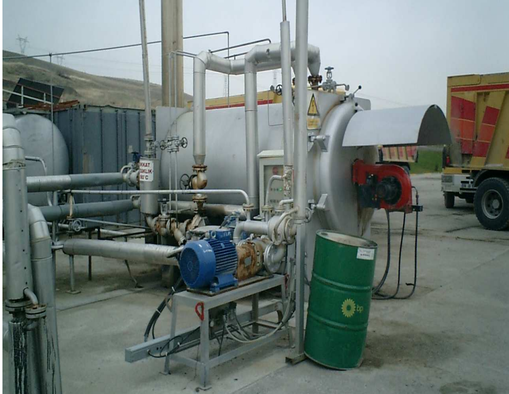
Şekil 2.17: Kızgın Yağ Tankı (Çetin İşletmeleri, Ağırıklı Tip Asfalt Plenti, Ankara)
