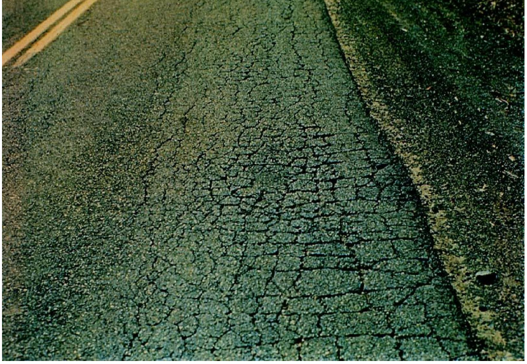
Şekil 2.1 : Timsah sırtı çatlak (yakın).
