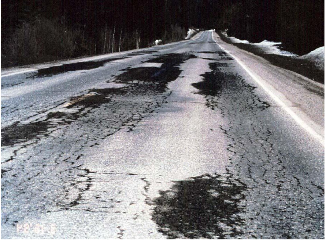
Şekil 2.2 : Timsah sırtı çatlak (uzak).
