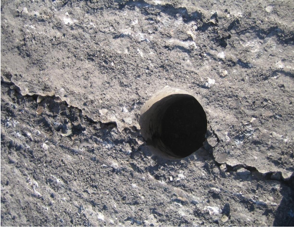
b) Çatlaklı kesimden alınan karot
