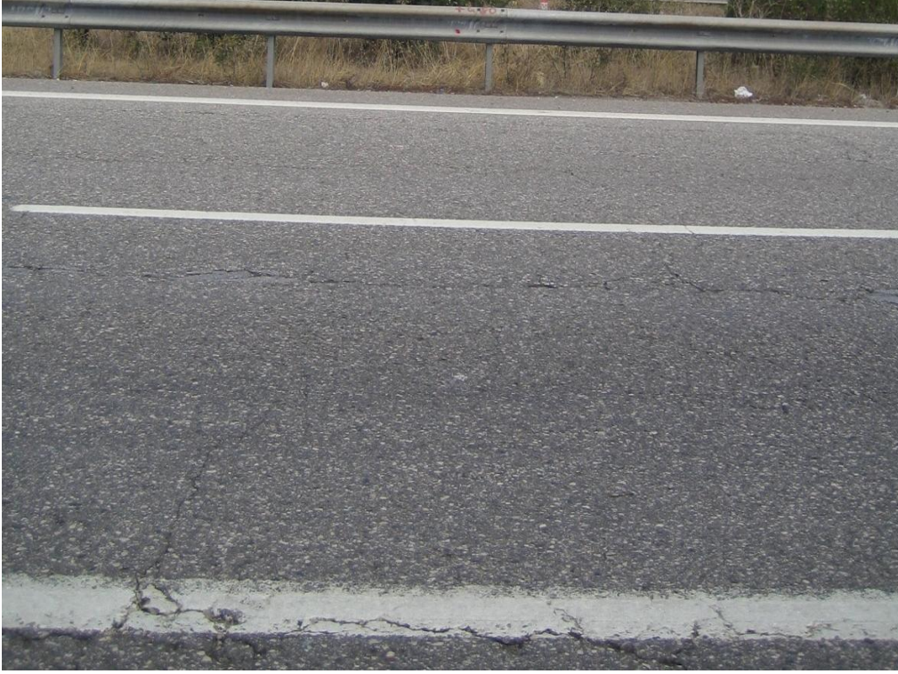
a) Kaplama sıcaklık deęişimlerinden meydana gelen bozulmalara ait bir görünüş
