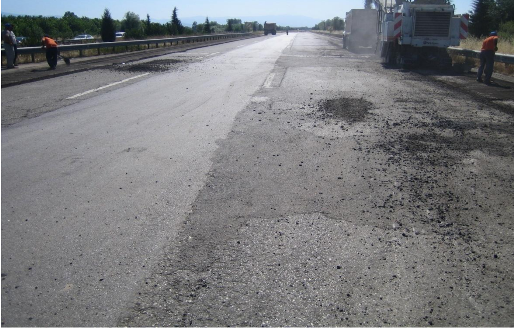
c) Onarım öncesi görünüş
