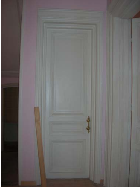
Şekil B37 – Z06 mekanı kapatılmış kapısı
