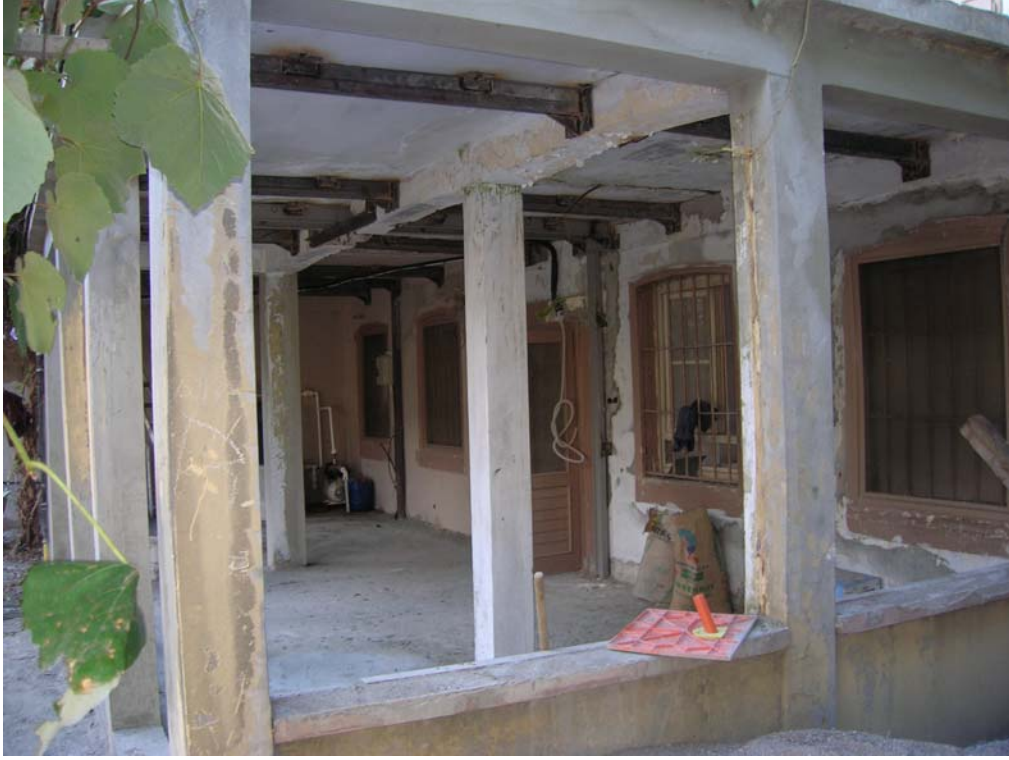
Şekil B199 – Bodrum kat verandada bulunan çelik profiller
