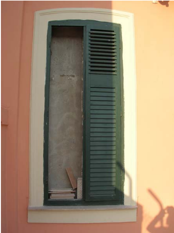
Şekil B45 – Z09 mekanı kuzey duvarı üzerindeki kapatılmış pencere
