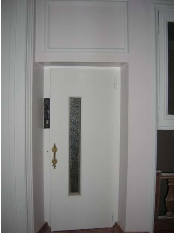
Şekil B174 – Birinci kat ve bodrum kat asansör kapıları
