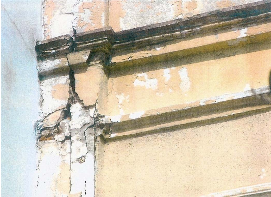
Şekil B202 – Hasarlı silmeler
