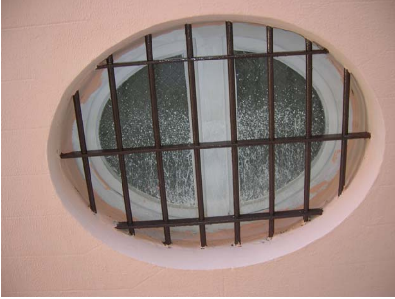
Şekil B194 – Kiler mekanı elips pencereleri önündeki demir parmaklıklar
