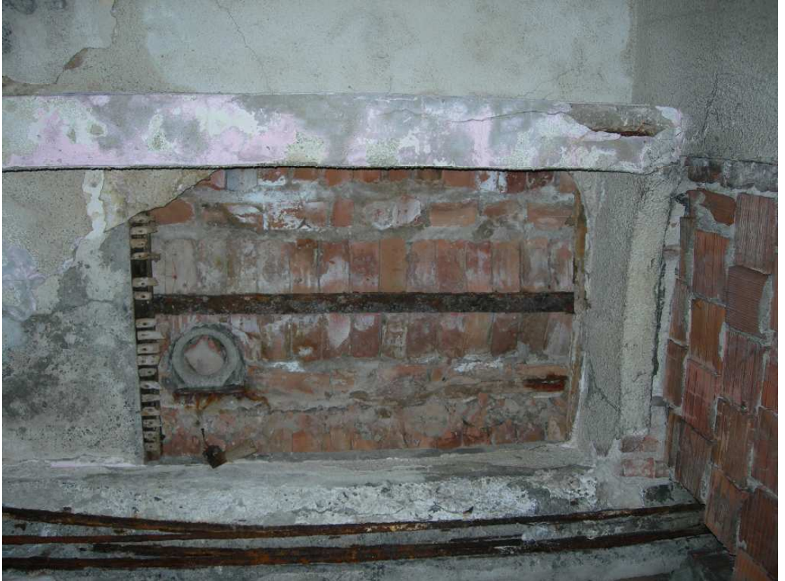
Şekil C.25. ZK06; mekanın tavanında görülen sıva dökülmesi ve demir donatılar
