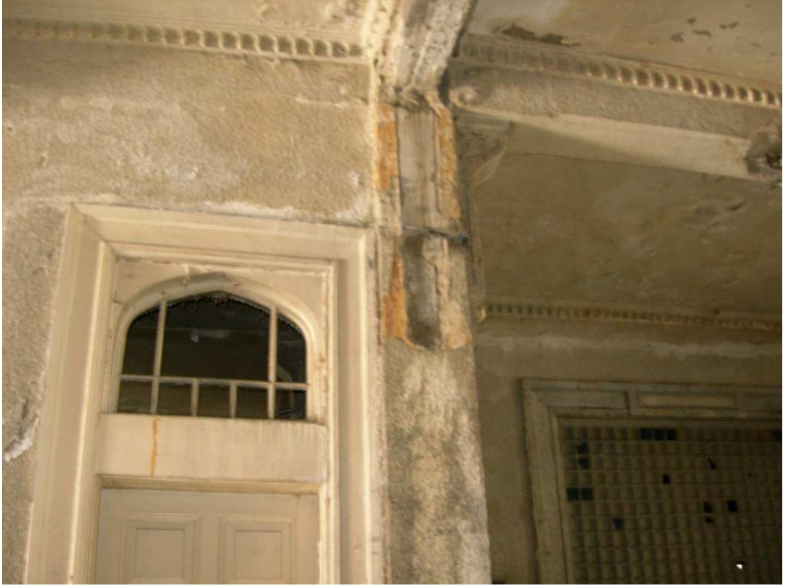
Şekil C.14. ZK02; güney duvarındaki alçı konsol
