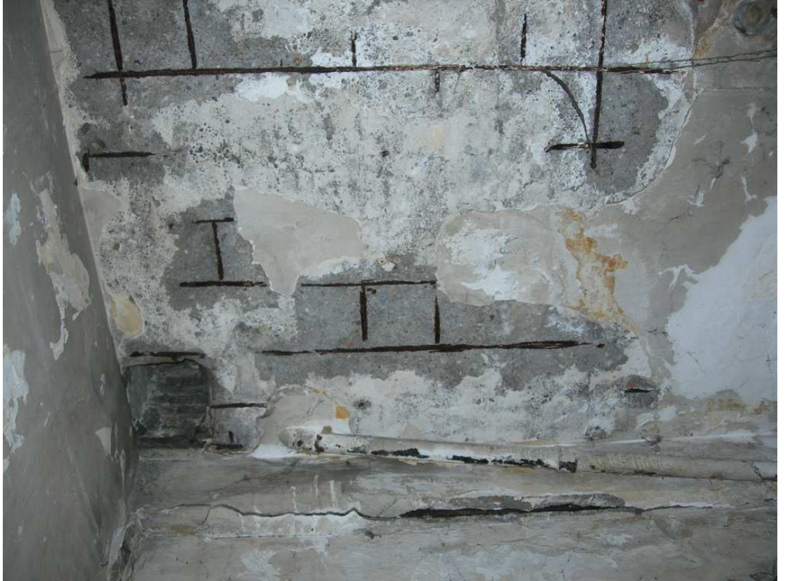
Şekil C.55. ZK16; WC' nin tavanında sıva dökülmesi
