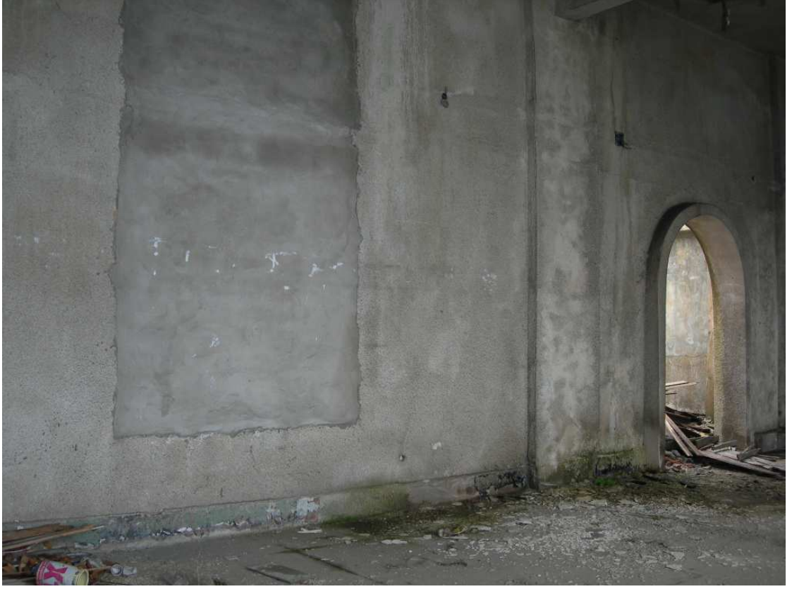
Şekil C.137. BK16; salonun batı duvarında örülerek kapatılmış pencere BKK01
