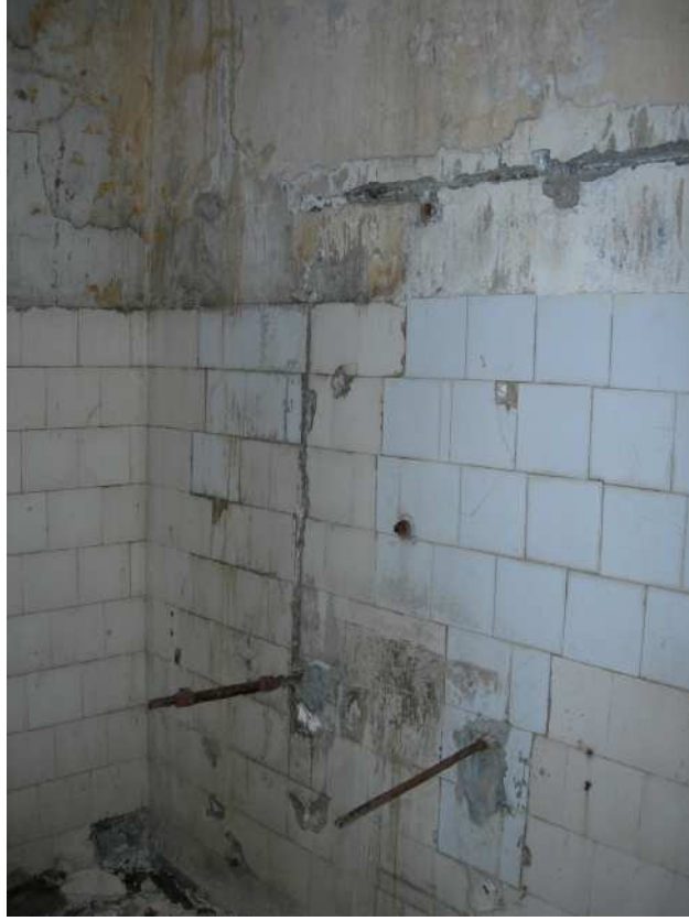
Şekil C.94. BK03; WC' nin batı duvarındaki donatılar
