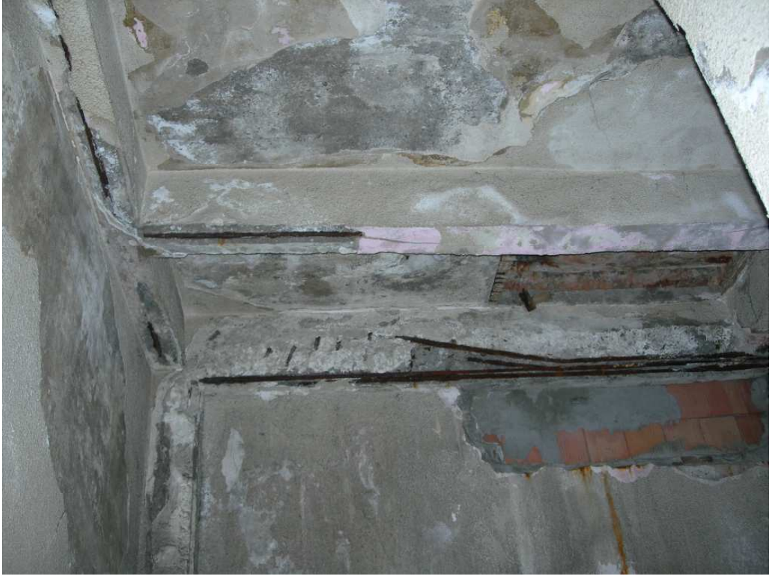
Şekil C.24. ZK06; mekanın tavanında görülen sıva dökülmesi ve demir donatılar
