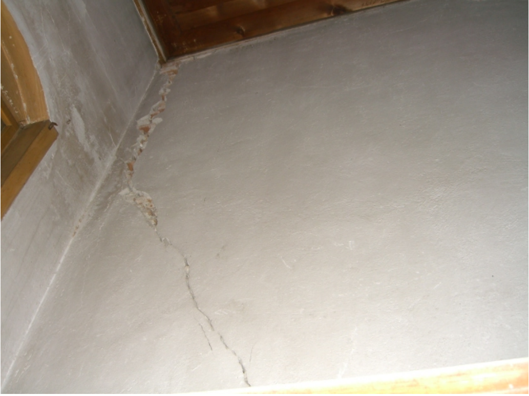
Şekil A.88: 103 mekânının doğu duvarındaki derin diyagonal çatlak
