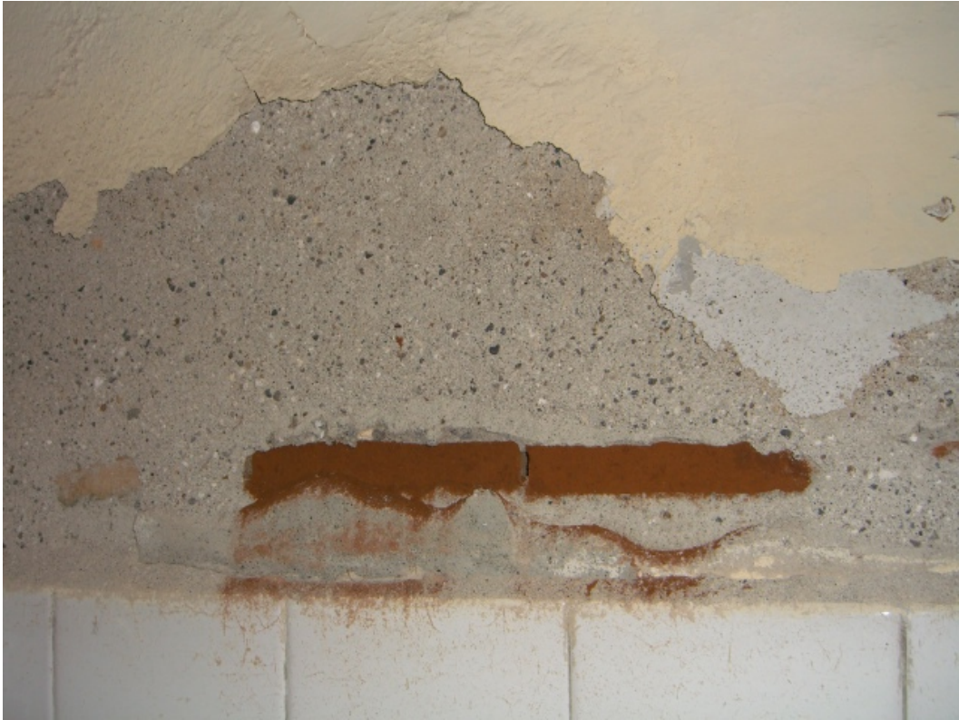
Şekil A.151: Z08 mekânının doğu duvarında görülen çimento harcı siva ve toz halinde dökülmeye başlamış tuğlalar
