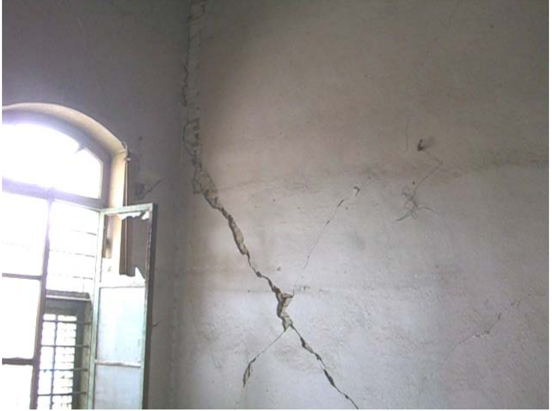
Şekil A.100: 105 mekânının batı duvarındaki derin diyagonal çatlak
