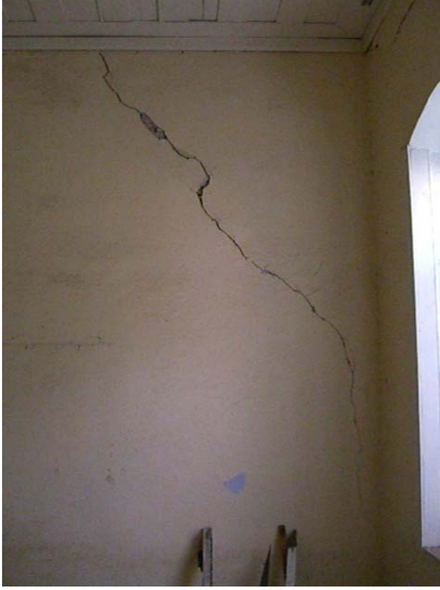
Şekil A.44: Z04 mekânının batı duvarındaki derin çatlak
