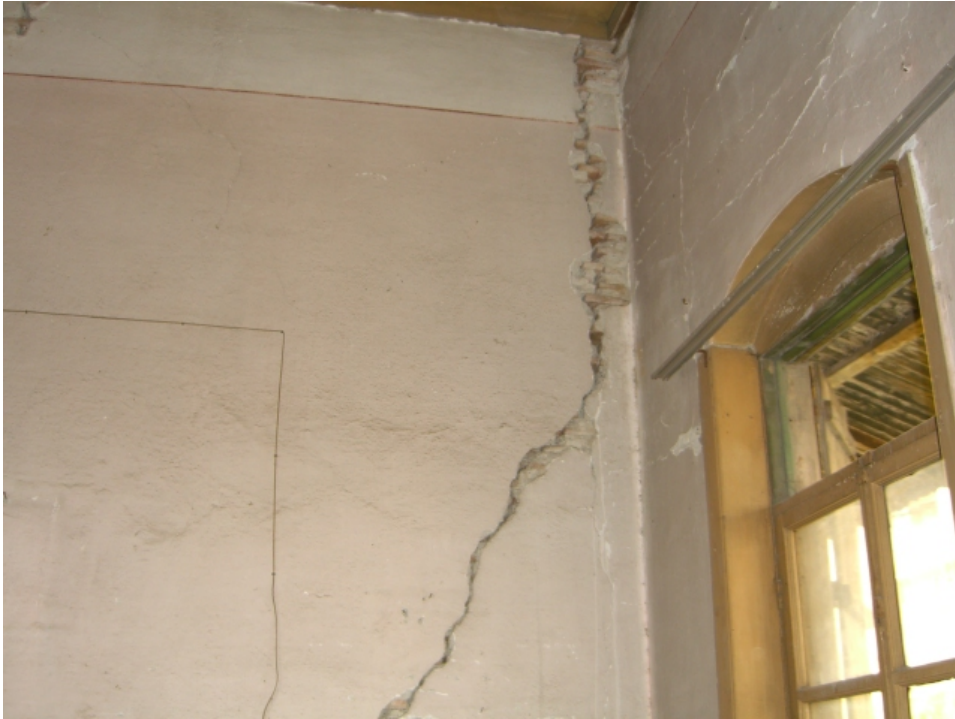
Şekil A.95: 104 mekânının batı duvarındaki derin çatlak
