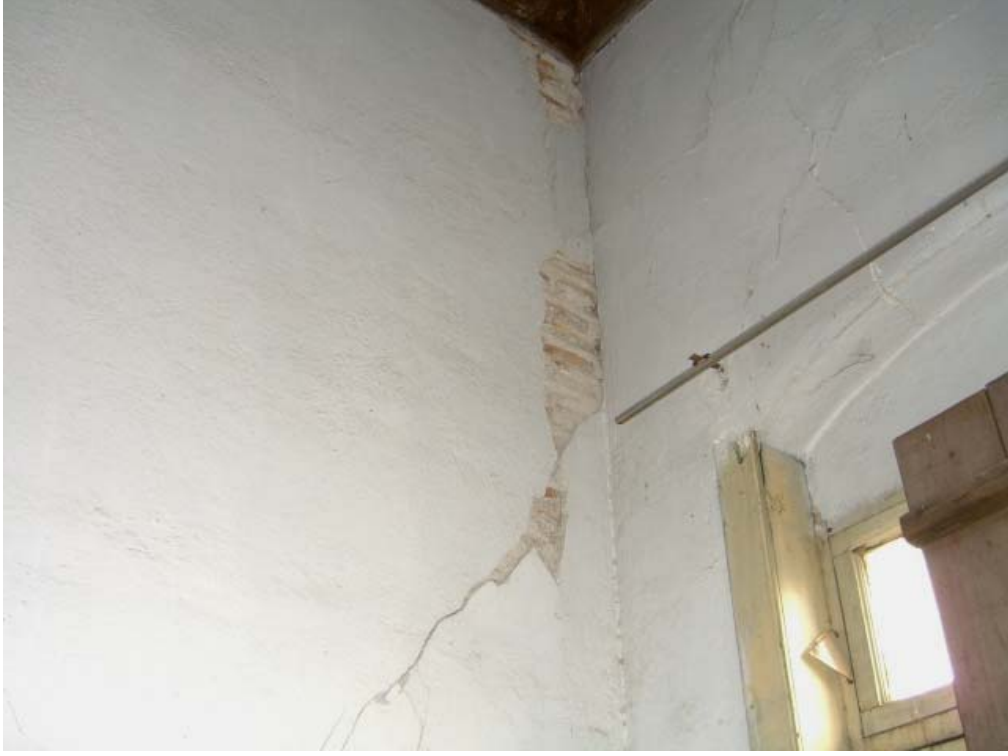
Şekil A.102: 106 mekânının doğu duvarında yer alan derin çatlak
