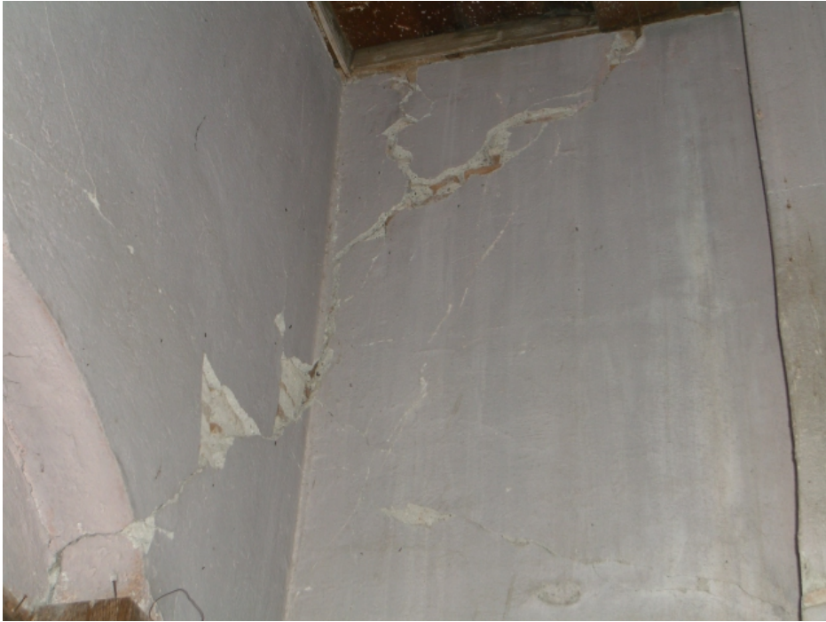
Şekil A.83: 102 mekânının kuzey duvarından başlayan ve batı duvarında devam eden derin çatlak
