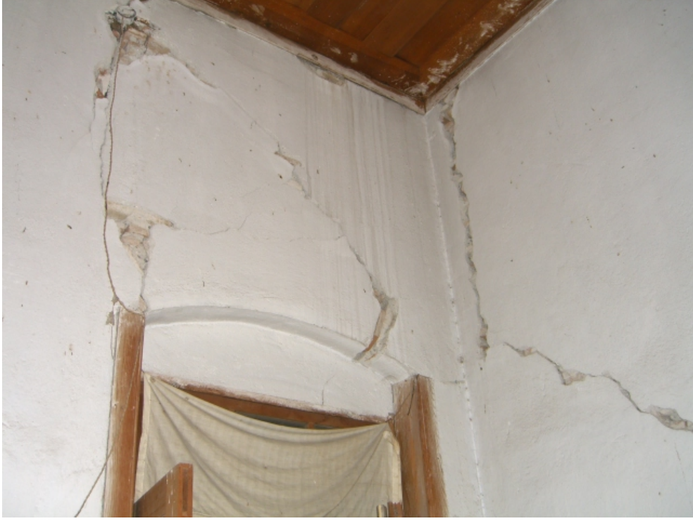
Şekil A.106: 107 mekânının kuzey duvarında yer alan kapının üzerindeki ciddi çatlaklar
