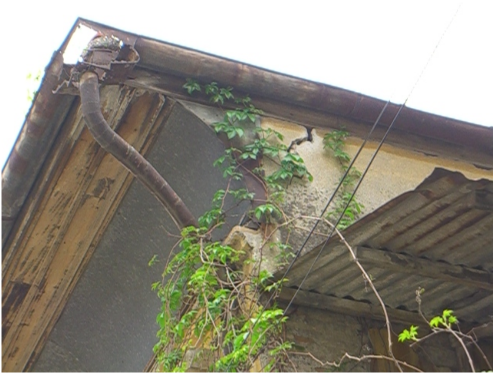
Şekil A.125: Doğu cephesinin kuzey cephesi ile birleştiği noktada kesilen içbükey çinko saçak
