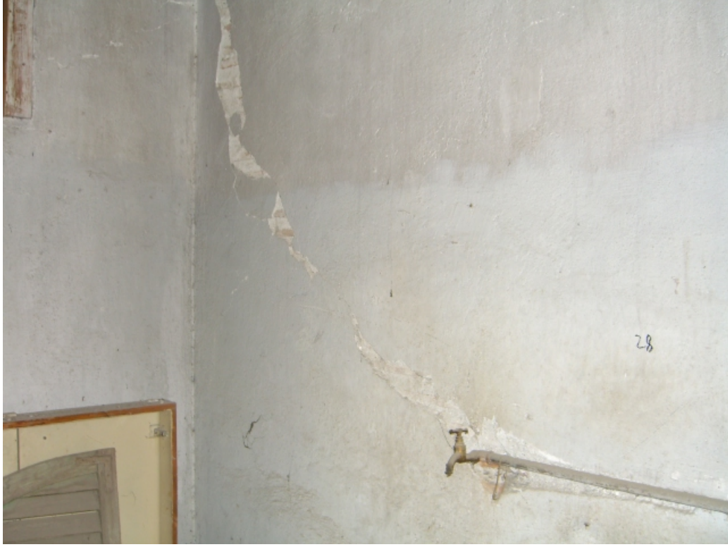
Şekil A.110: 108 mekânının batı duvarındaki derin çatlak
