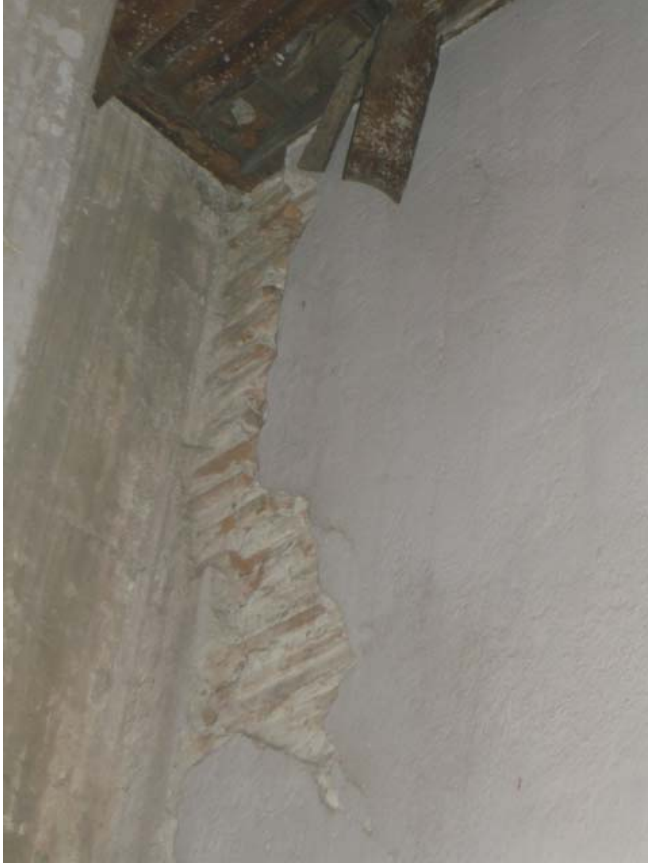
Şekil A.82: 102 mekânının doğu duvarındaki derin çatlak
