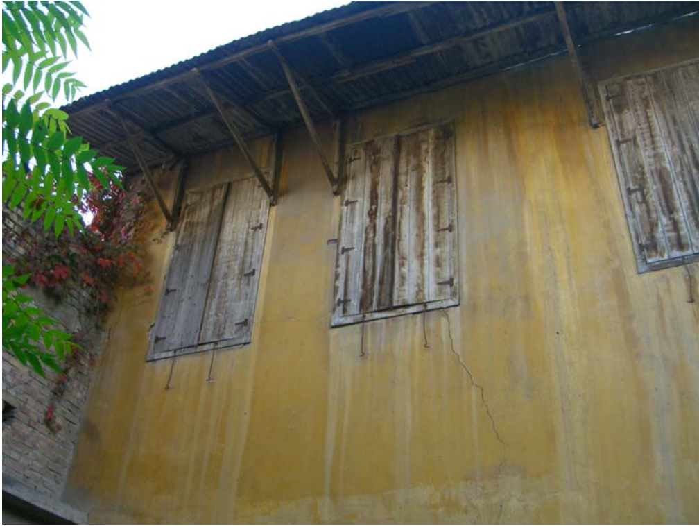
Şekil A.141: 103 (merdiven kovası) ve 104 (oda) mekânlarının kuzey yönündeki pencereler ve bu pencerelerin üzerindeki basit çinko saçak
