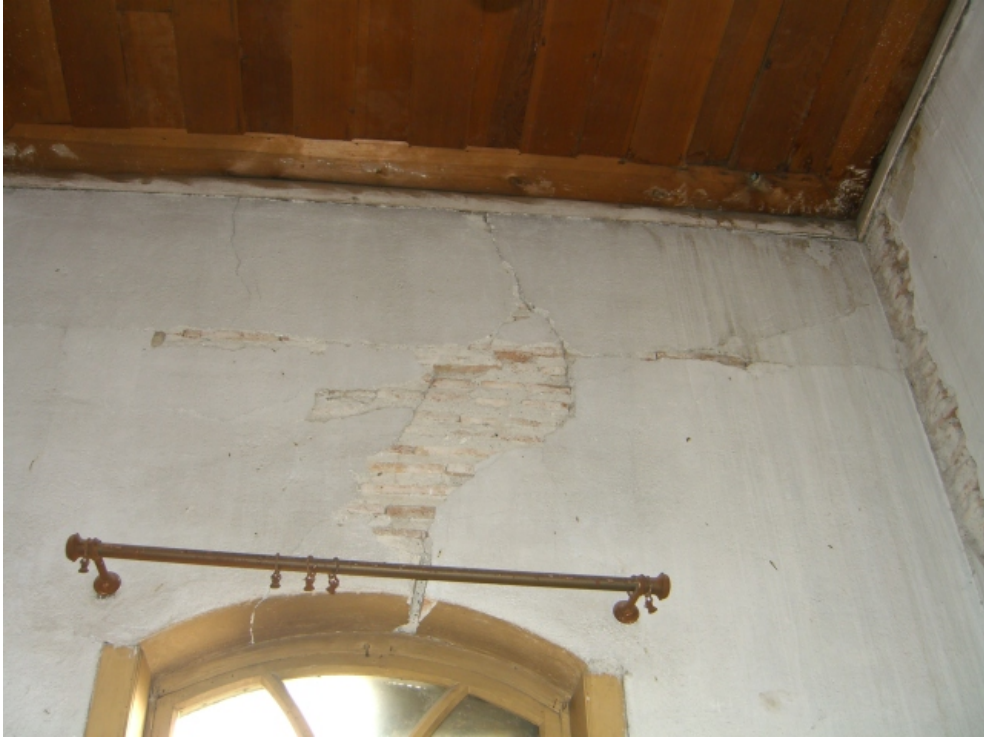
Şekil A.107: 107 mekânının güney duvarında yer alan pencerenin üzerindeki ciddi çatlaklar
