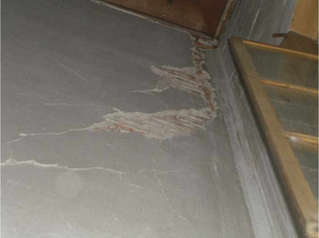
Şekil A.89: 103 mekânının batı duvarındaki derin çatlak
