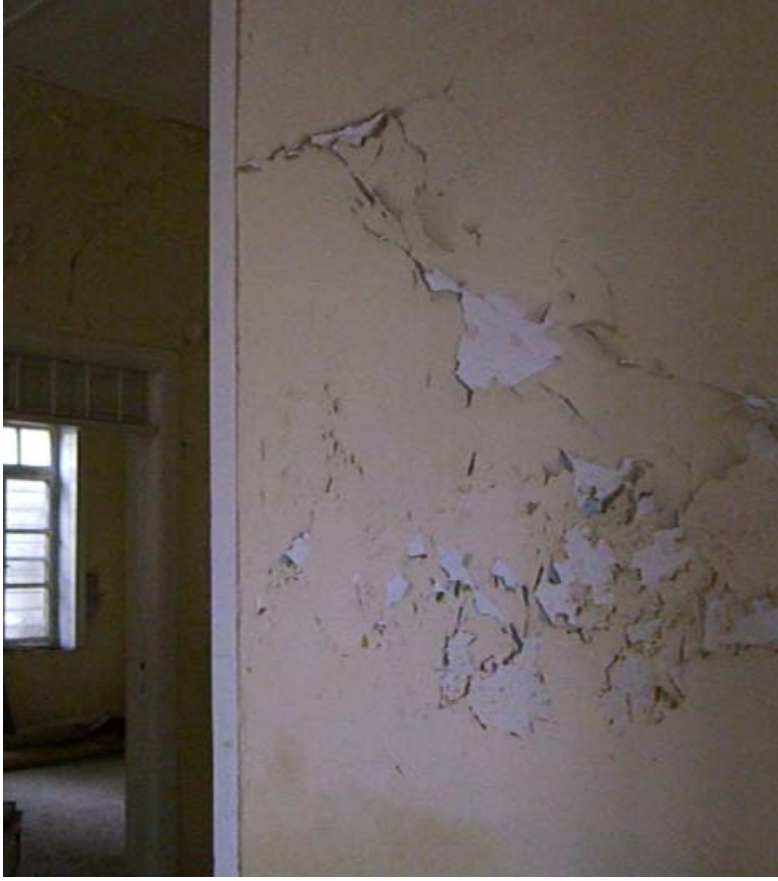
Şekil A.152: Giriş holü bölümünün doğu duvarında rutubet etkisi ile görülen boya kabarmaları ve dökülmeler
