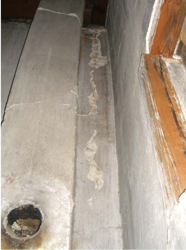
Şekil A.109: 108 mekânının doğu duvarındaki derin çatlak
