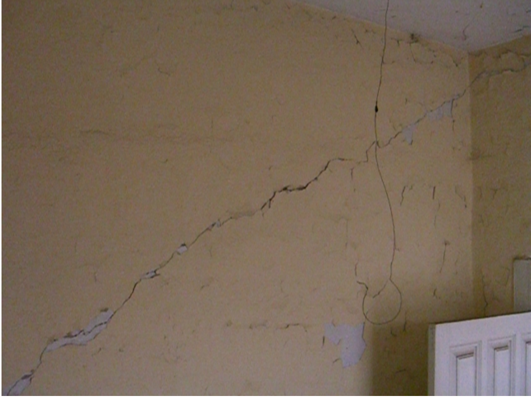
Şekil A.32: Z02 mekânının doğu duvarında yer alan derin diyagonal çatlak
