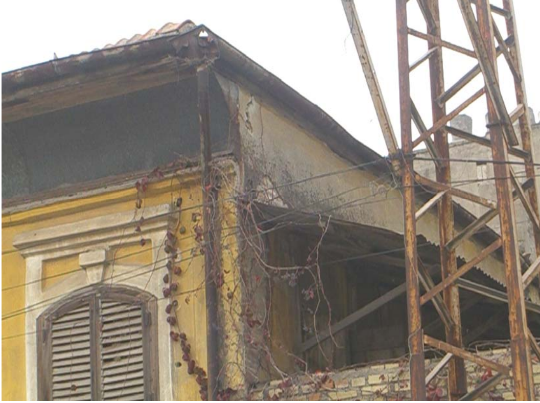
Şekil A.142: Kuzey cephesinde devam etmeyen içbükey çinko saçak
