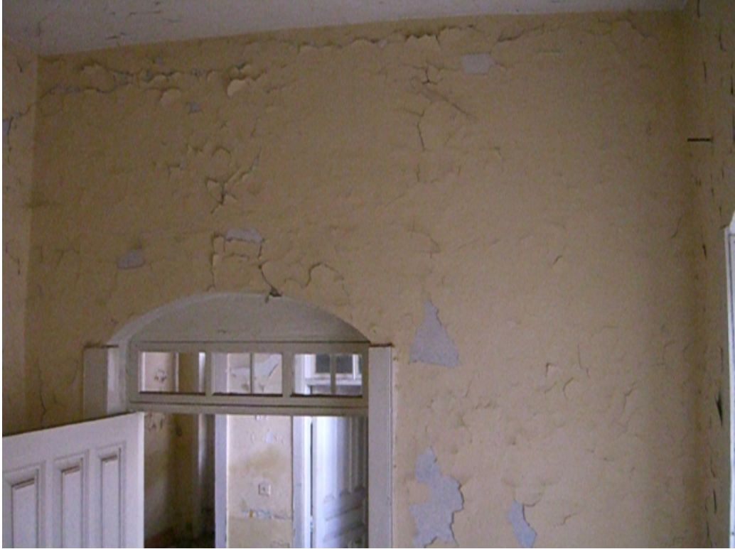
Şekil A.31: Z02 mekânının duvarlarındaki boya kabarması ve dökülmesi
