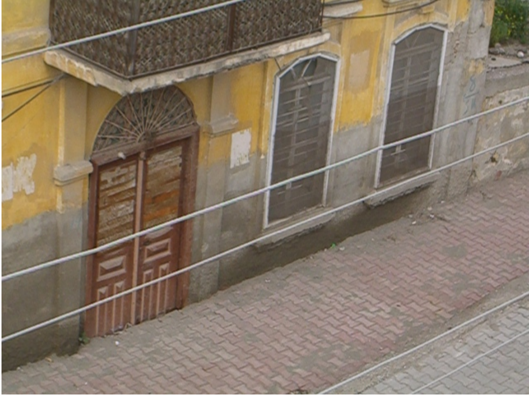
Şekil A.128: Şubat 2006’da yapılan yeni kaldırım döşemesine göre eşik kotu aşağıda kalan giriş kapısı
