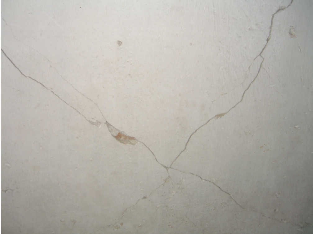
Şekil A.103: 106 mekânının batı duvarında yer alan çatlakların kesiştiği nokta
