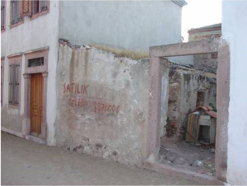
Şekil D.23: Şeref Sokak no. 27'deki harap tescilli yapı
