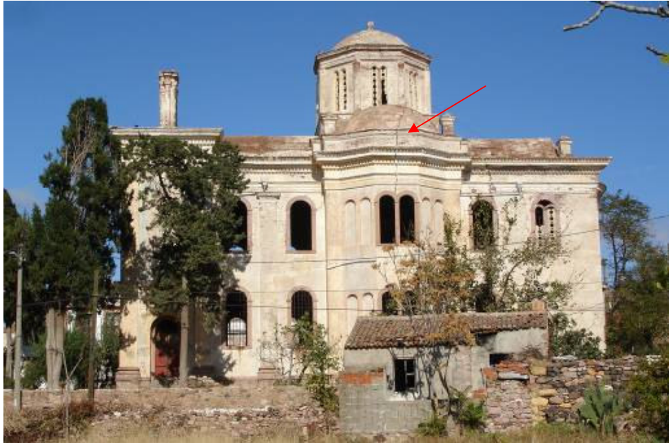
Şekil B.19: Taksiyarhis Kilisesi'nin güney cephesindeki çatlaklar
