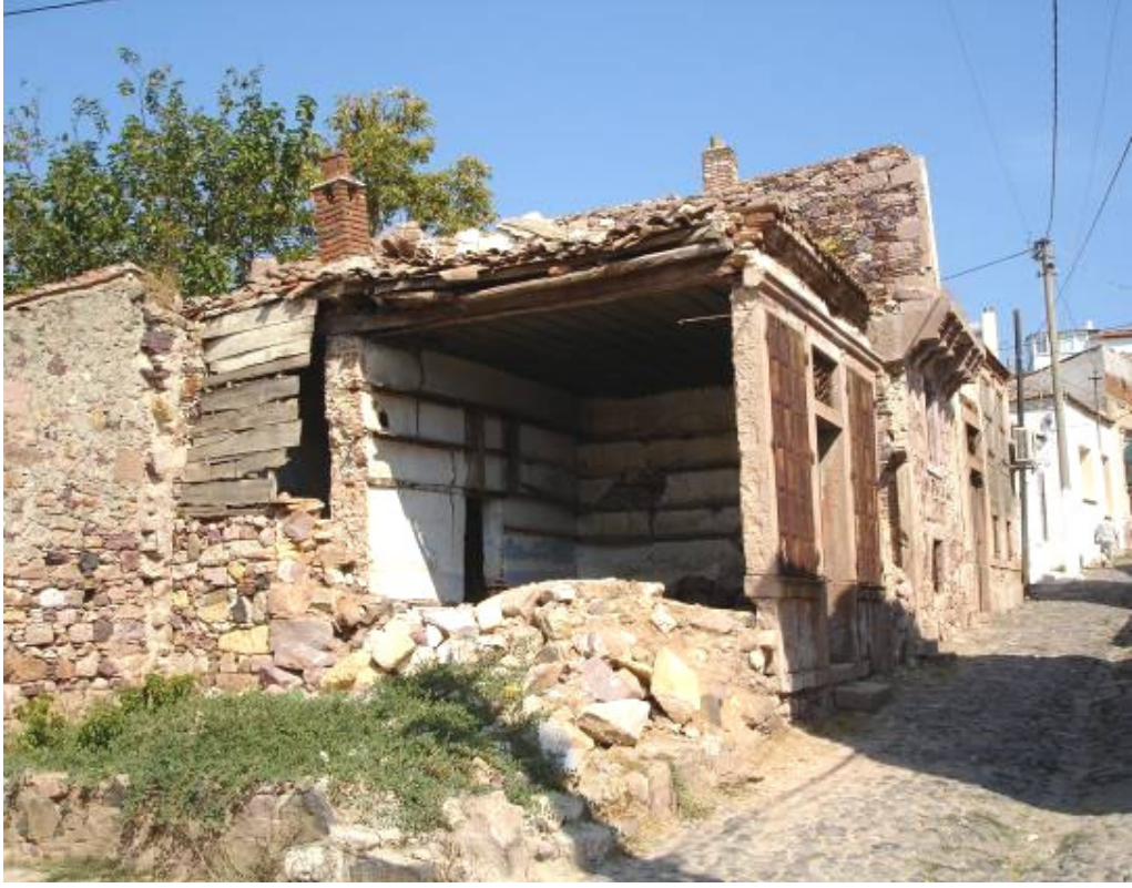
Şekil D.22: Şeref Sokak no. 37 ve 39'daki yıkık yapılar
