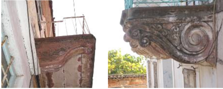
Şekil B.72: Tepebaşı Sokak no. 12 ve no.13'deki taş balkon konsolları
