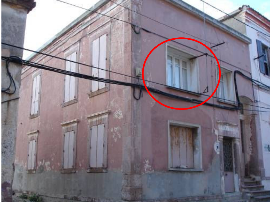
Şekil D.18: Selamet Caddesi no.19'daki değişmiş pencereler ve özgün olanlar
