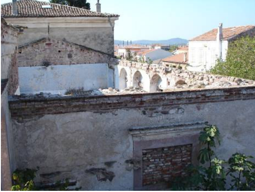
Şekil B.32: Taksıyarhis Kilisesi'nin kuzeyindeki yıkık yapılardan biri
