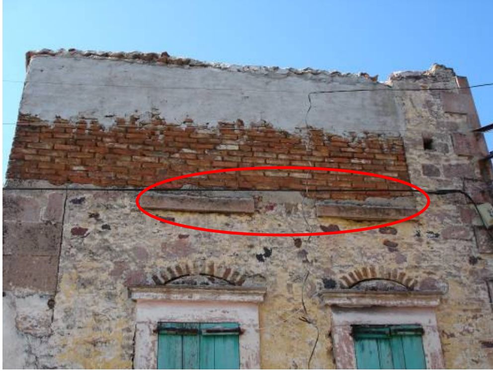
Şekil D.20: Hayret Sokak no. 1'deki konutun yıkılıp tuğla ile örülen üst katı ve özgün pencere söveleri
