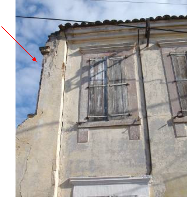
Şekil D.25: Aynı yapının pencere izi
