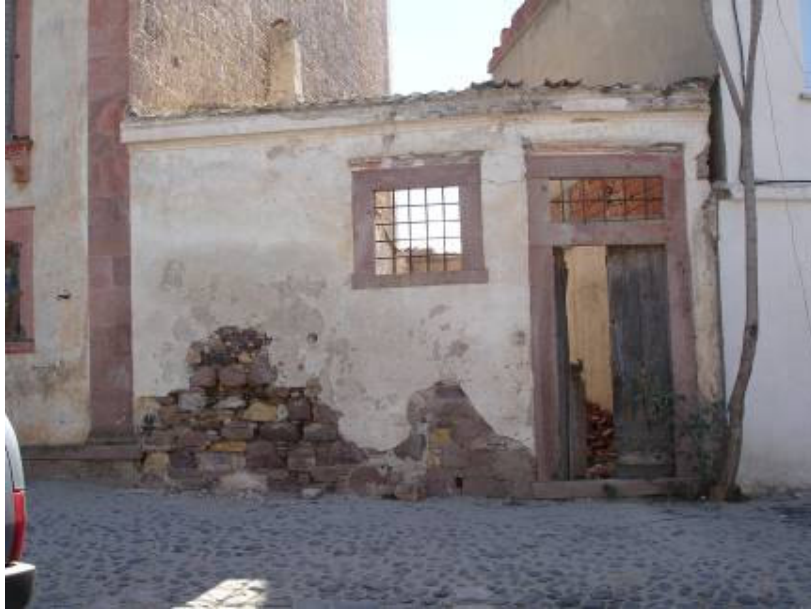
Şekil D.21: Şeref Sokak no. 3'teki yıkık yapı
