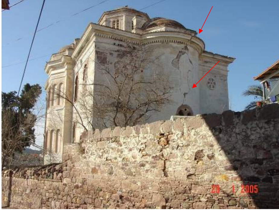
Şekil B.20: Taksiyarhis Kilisesi'nin doğu cephesindeki çatlaklar
