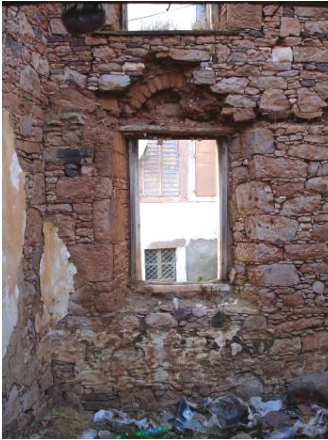
Şekil B.156: Çöken duvarlar
