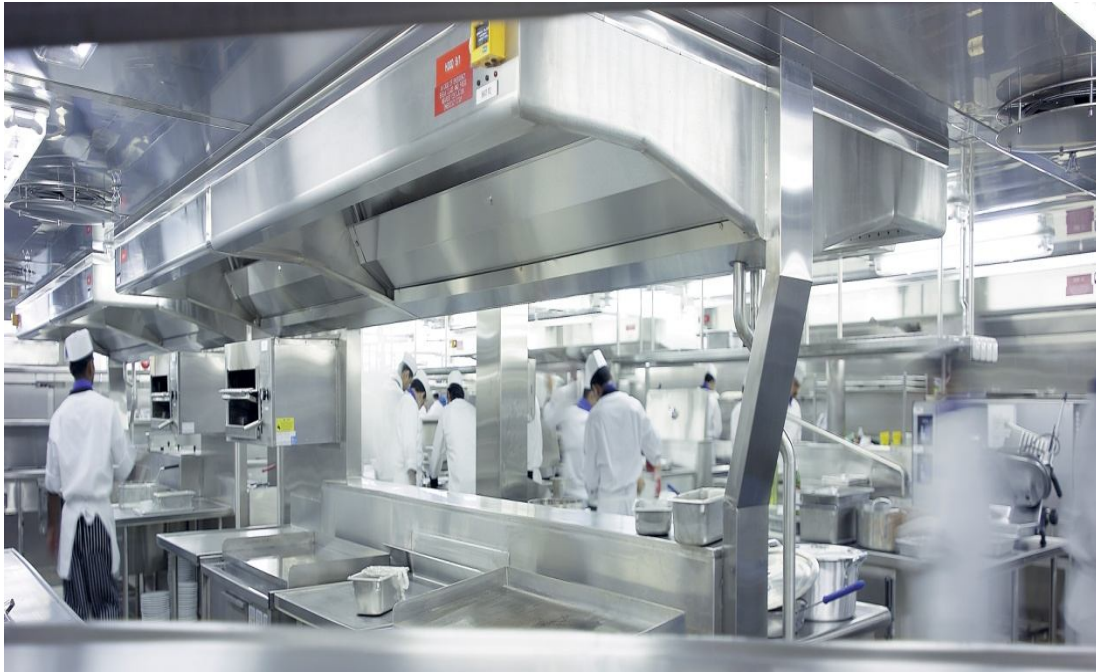
Şekil 3.2 : Gemi mutfağı havalandırması
