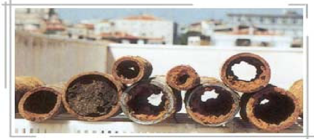
Şekil 5.8 Tıkanan Kanalizasyon Boruları
