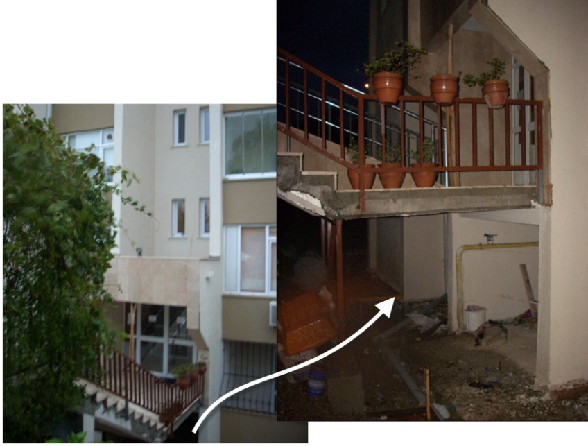
Şekil 7.16 : Bina-3 zemin kat, giriş merdiveninin altı.
