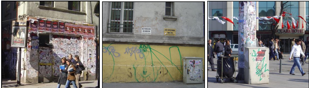
Şekil 6.52. : a- İlan kalıntıları ile kaplı cephe örneği b-c Grafiti vandalizmine uğramış cephe ve direk örneği (Fotoğraf : Günseli Döllük)
