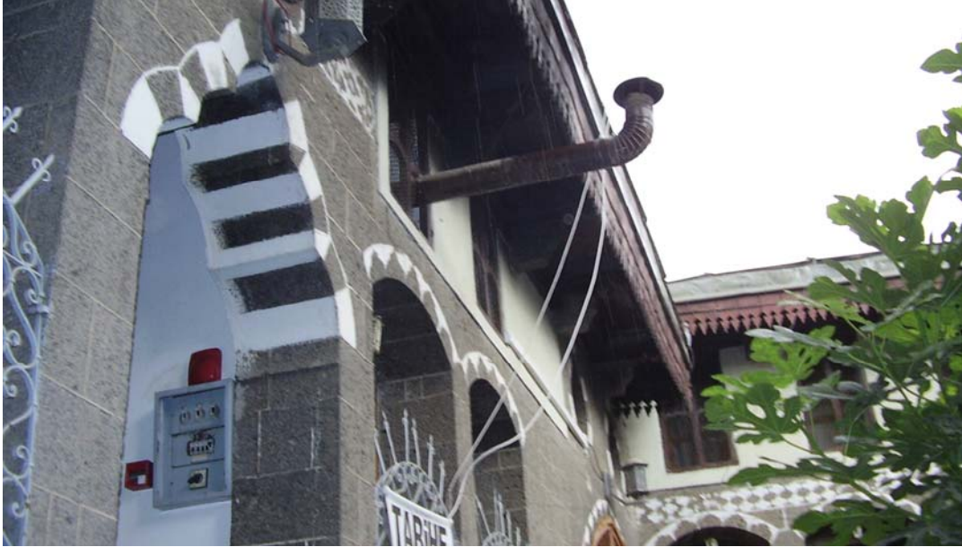
Şekil 6.10: Geleneksel Diyarbakır evlerine sonradan yapılan müdahaleler, camdan çıkartılan boru ve taş duvarda bulunan elektrik panosu (Dizdar 2009)
