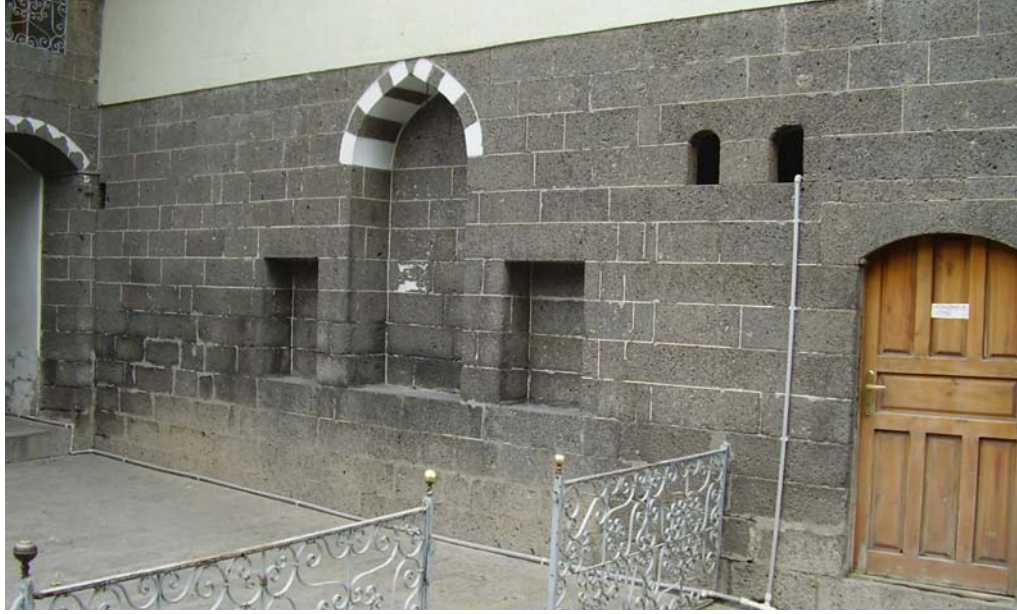
Şekil 6.11: Geleneksel Diyarbakır evlerine sonradan yapılan müdahaleler, plastik boruların avlu etrafında dolaştırılması (Dizdar, 2009)
