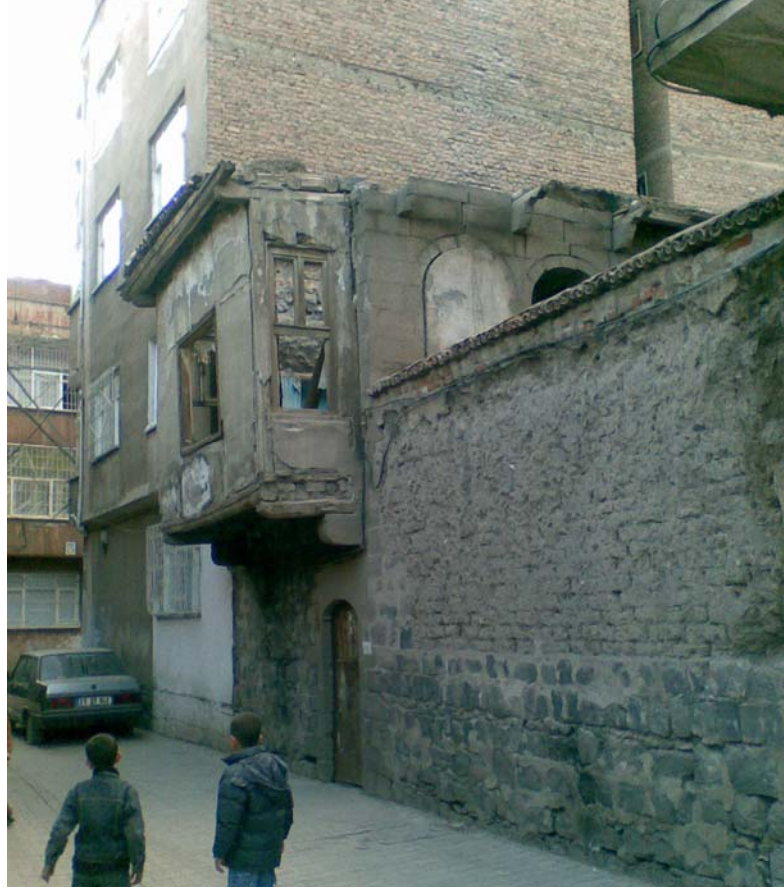
Şekil 5.18: Geleneksel Diyarbakır evinin eskimesi (Dizdar, 2009)
