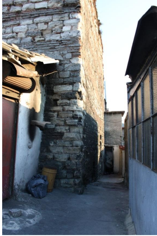
Şekil 2.13 : Kuzey cephesinin batı tarafında tamir edilmiş bölüm (sağ taraftan batı cephesinin 7 metre kotundaki penceresine geçiş).
