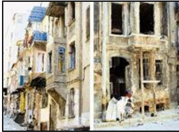
Şekil 5.1. Beyoğlu Bölgesindeki Kötü Durumdaki Konutlar
