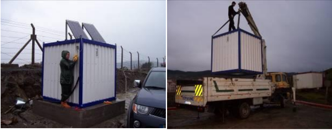
Şekil 4.12 : K.S.İ. Üniversitesi Kampüs tilt istasyonu için su basmanı kaidesi üzerinde kulübenin yerleştirilmesi ve enerji kaynağının güneş panelleri ile sağlanması.
