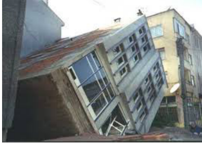
Şekil 4.4 : Sıvılaşmış zeminde batma problemi oluşan bir bina
