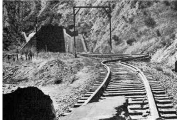
Şekil 6.4 : Tünel raylarındaki bozulmalar
