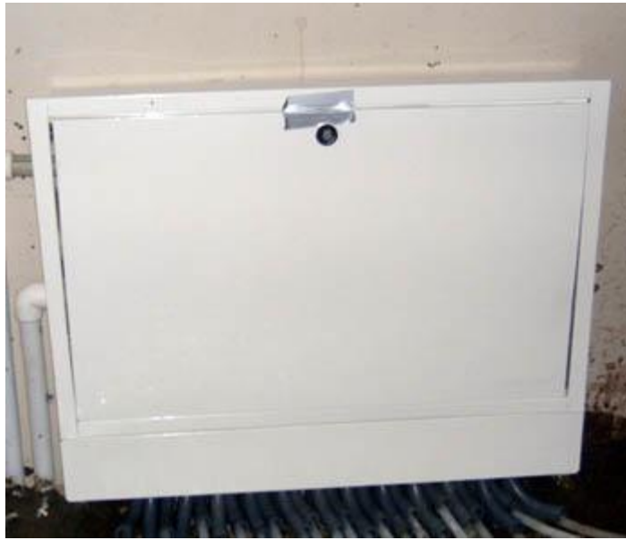
Şekil 4.55 Yerden ısıtmada sıcaklık kontrol kutusu (Kolektörü) [50].
