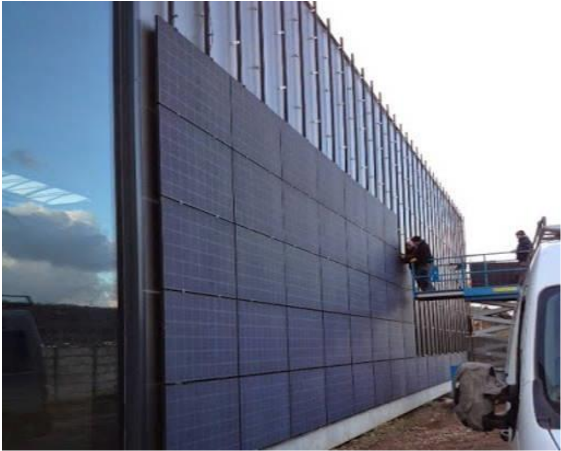
Şekil 3.7 : Bina cephesi üzerine montaj yapılan FV sistem.
