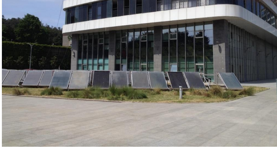
Şekil 1.16 : Arı 3 binasının bahçesinde kurulu güneş enerjisi sistemi.
