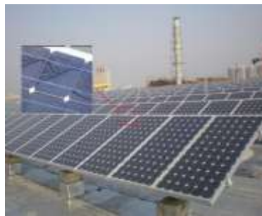
Şekil 4.4 : Fotovoltaik panellerde gözlenen salyangoz izi lekesi [63].
