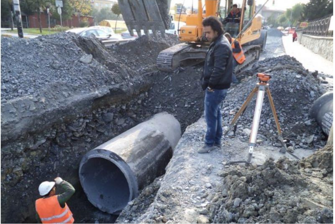
Şekil 3.2 : İş güvenliğine aykırı bir altyapı çalışması (Url-2).
