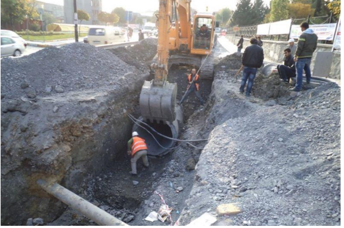
Şekil 3.1 : İş güvenliğine aykırı bir altyapı çalışması (Url-2).
