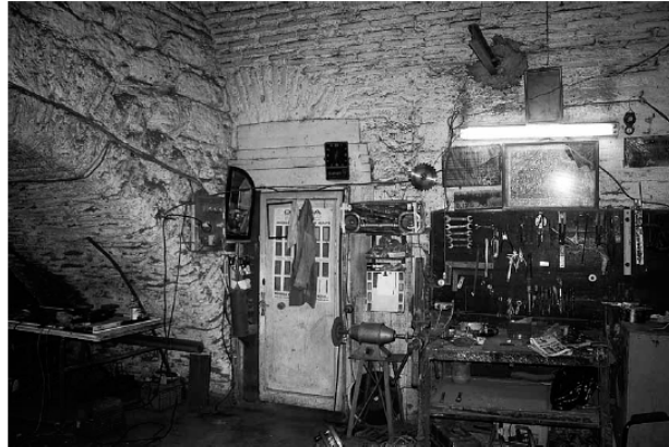
Şekil 5.7 : Karpos - Papylos/Menas kilisesi'nde tahribatın boyutları [27].
