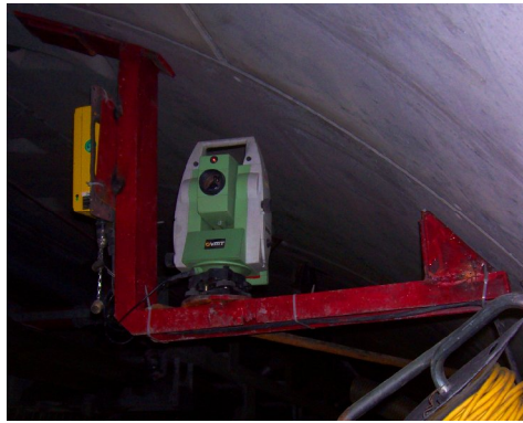
Şekil 9.6 : Yönlendirme Poligonu Konsol Tesisi
