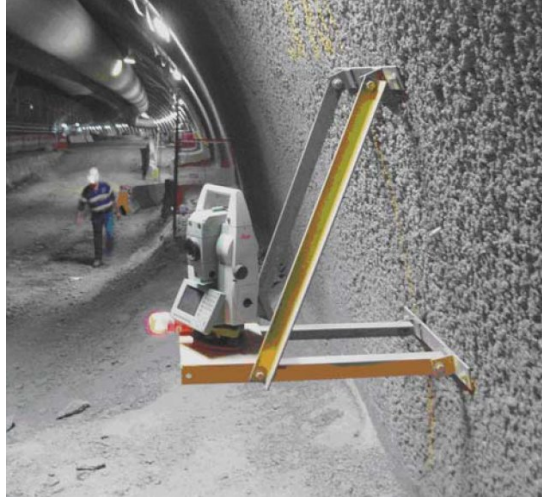
Şekil 4.1 : Tünel içi Nokta Tesisi
