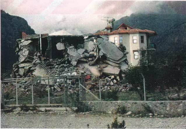
Foto.4.5. Göynük Belediyesi tarafından yıkılan bir kaçak yapı
