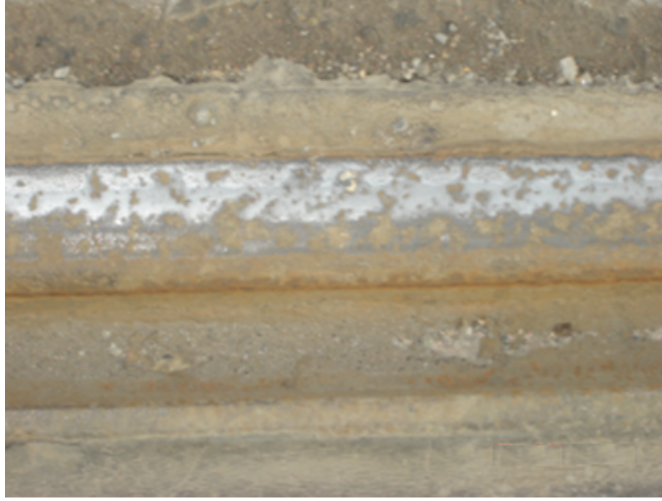
Şekil 4.3 : Yuvarlanma yüzeyinin kabuklanması.
