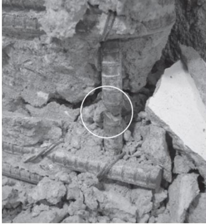
Şekil 2.7 : M-1.0-J numunesinde donatı kopması [Kuang ve Ho (2007)]
