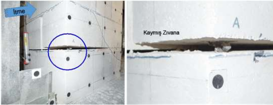
Şekil 2.19 : Ayak tabanındaki hasarın ve kurşun kaplama ile birlikte zivananın yakın görünüşü
