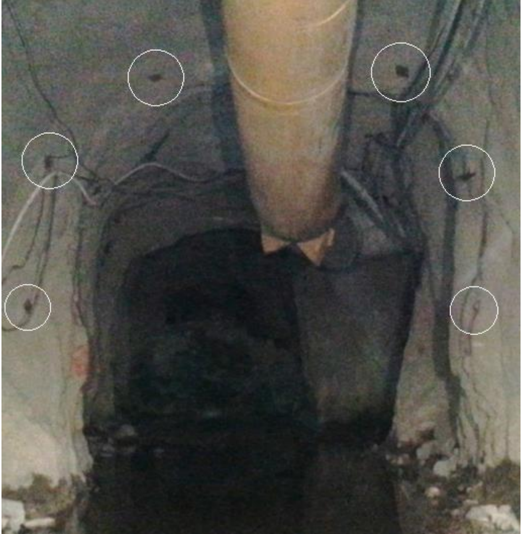
Şekil 6.10: Splitset uygulaması yapılmış bir galeri.
