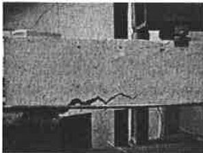
(a) beton örtü sıyrılması
