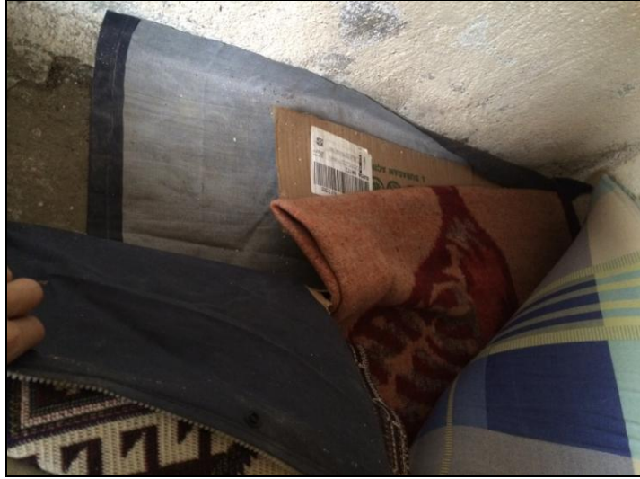
Şekil 4.44 : Ziyaret edilen konutlardaki su izolasyonu sorununu gösteren resim.
