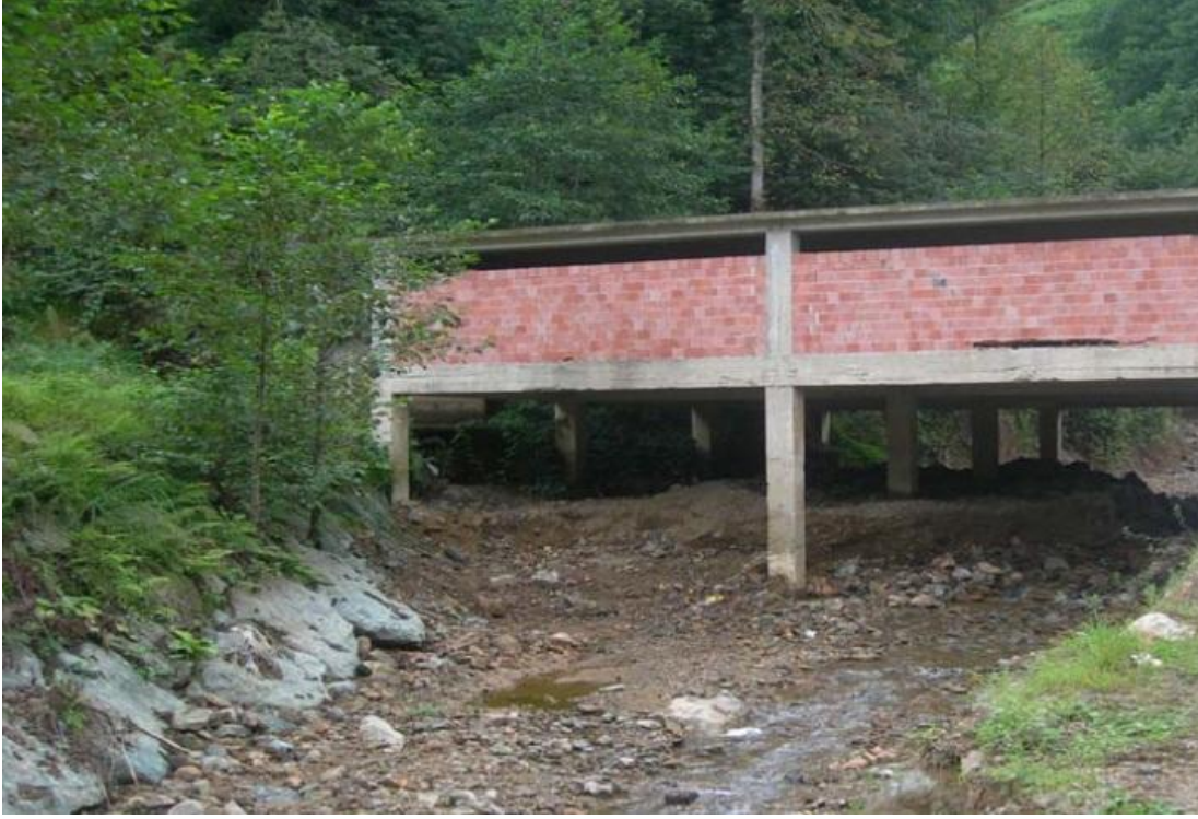
Şekil 3.28 : Dere yatağında bina yapımı [38].
