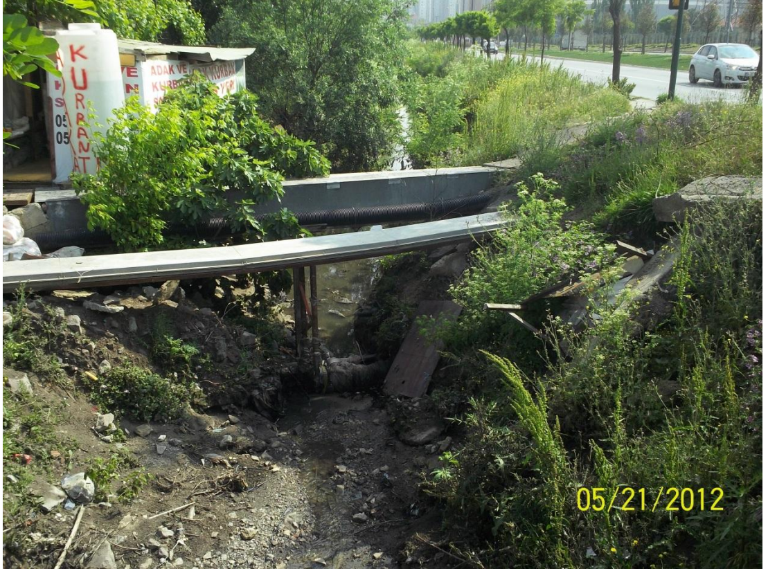
Şekil 3.3 : İmes Deresi elektrik hattı geçişi.
