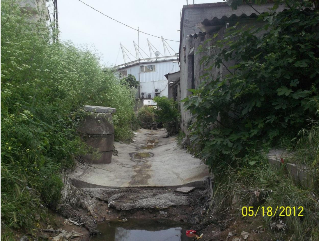
Şekil 3.6 : Çırçır Deresi yatağında bulunan atıksu toplayıcı hattı
