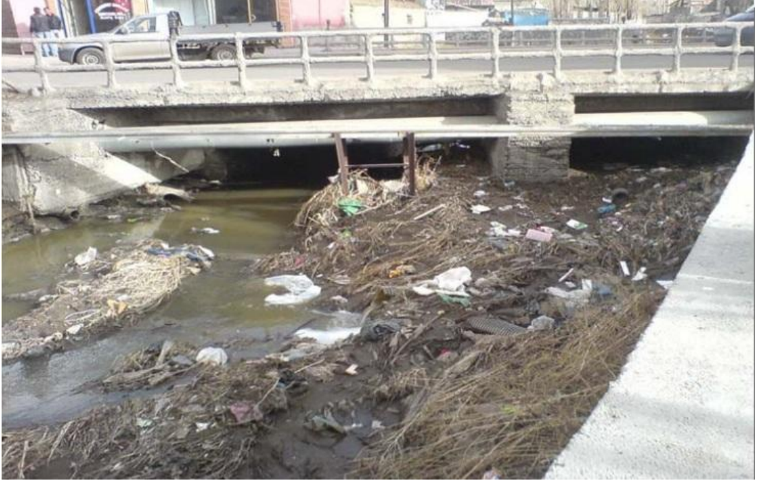
Şekil 3.30 : Dere kesitinin daraltılması ve hatalı boru geçişi [38].
