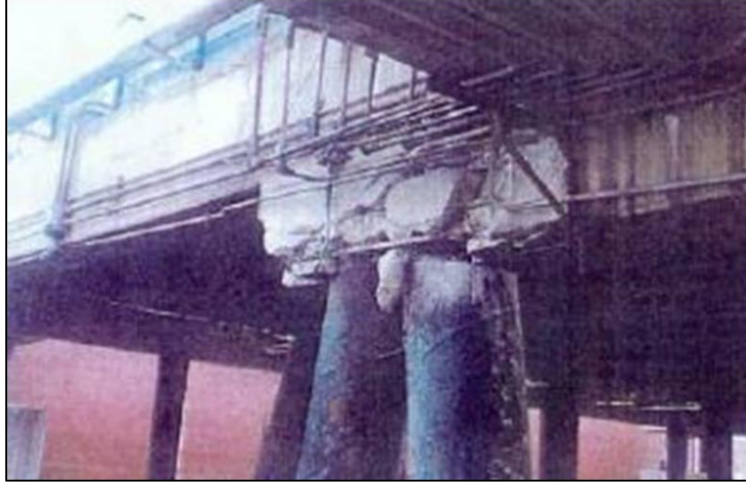
Şekil 6.17: Deprem sebebiyle hasar gören başlık kirişi.
