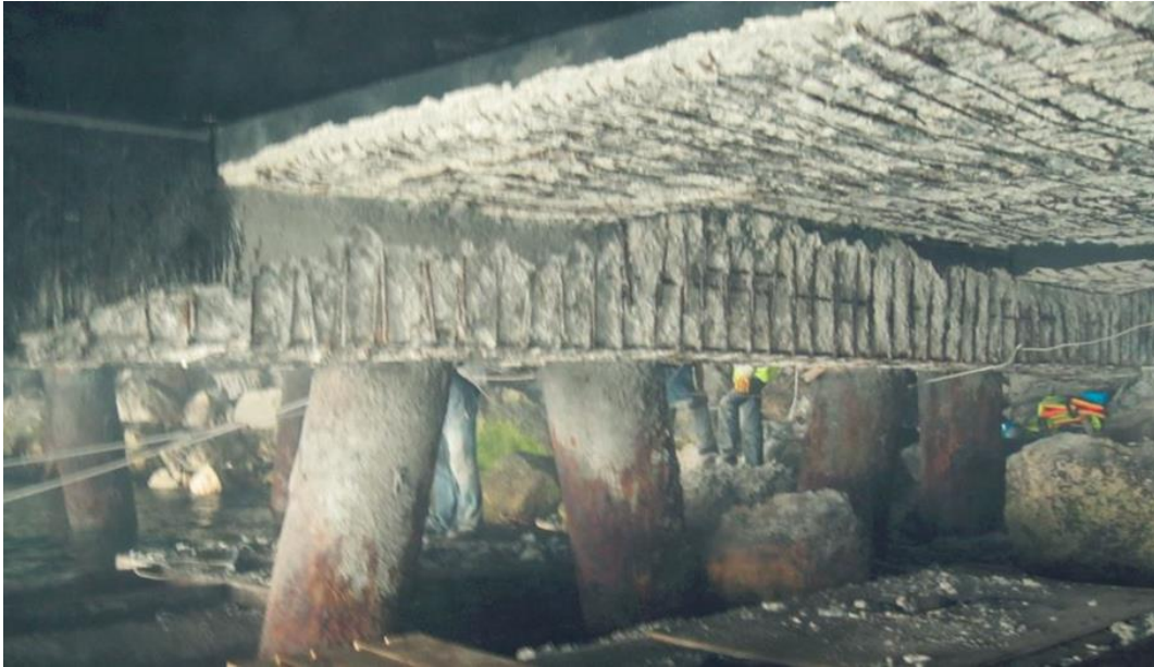
Şekil 6.15: Korozyon sebebiyle hasar gören üst yapı.
