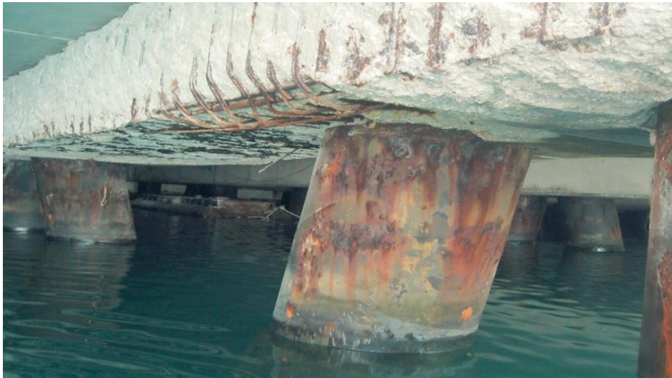
řekil 6.10: Korozyona maruz kalan kazık bařlık blęesi.
