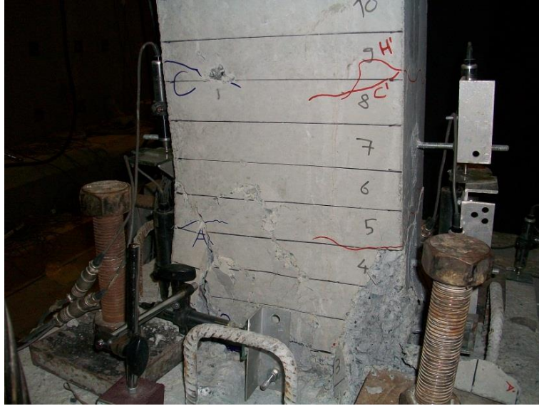
Şekil A.11 : REF numunesi deney sonrası kolon tabanında hasar durumu.
